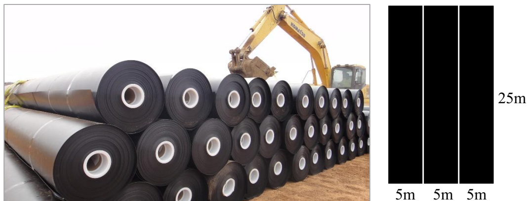
Figura 44 – Manta ou geomembrana impermeabilizante de PEAD
