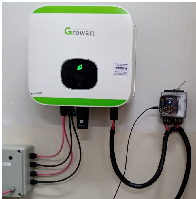
Figura 23 – Montagem do sistema de geração no laboratório.
