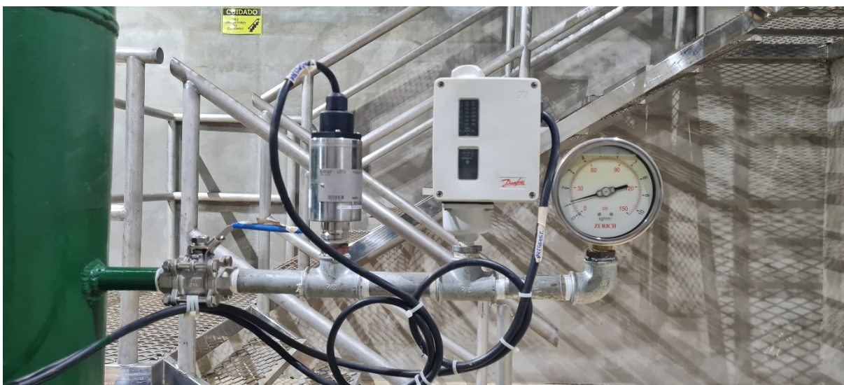
Figura 12: Transmissor de pressão, pressostato e manômetro da BA-001.
