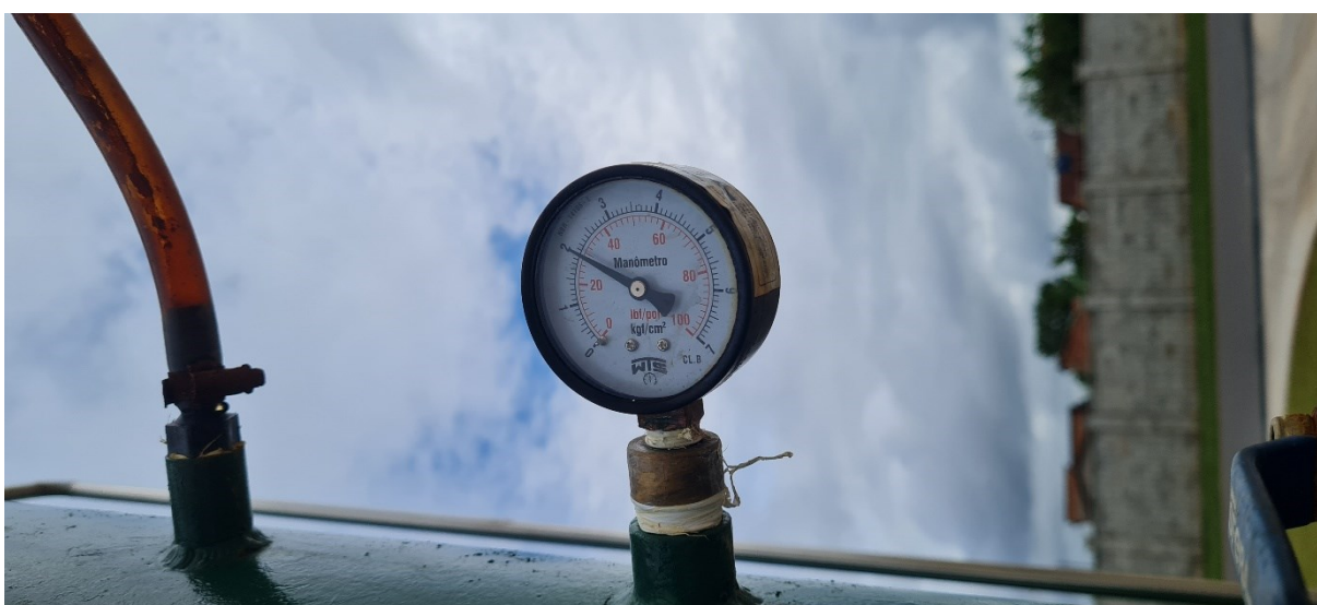
Figura 13: PI-005 - Pressão de entrada no floccodecantador.
