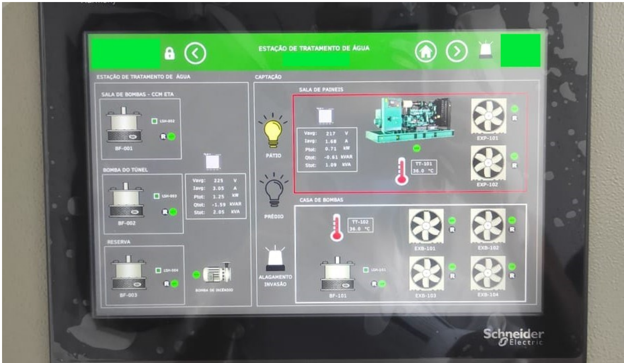
Figura 41: Tela de operação dos processos secundários da captação e ETA.
