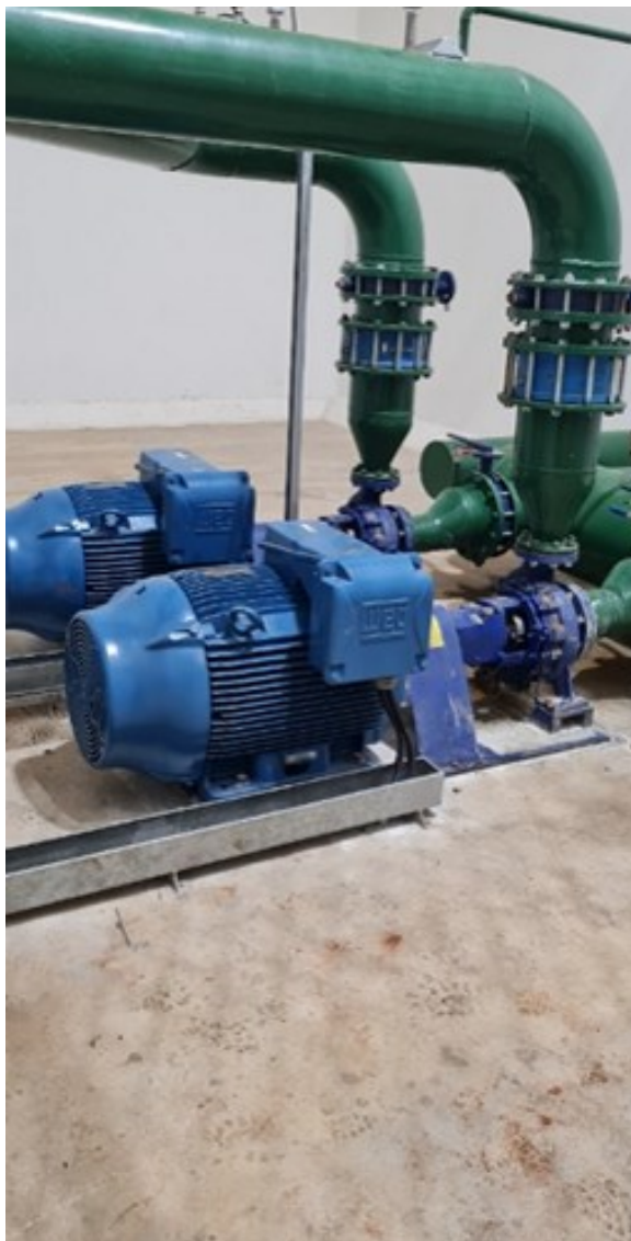
Figura 7: Bombas do sistema de captação BA-101 e BA-102.
