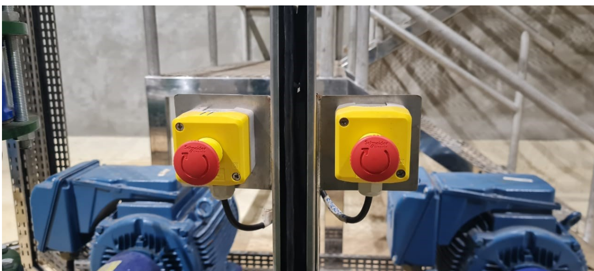
Figura 45: Botoeiras de emergência das bombas “BA-001” e “BA-002”.
