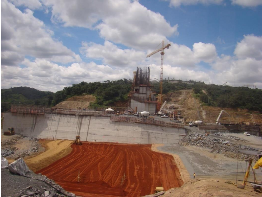
FIGURA 16. Fotografia. Construção da barragem UHE Serra do Facão Canteiro de obras (I), 2009
