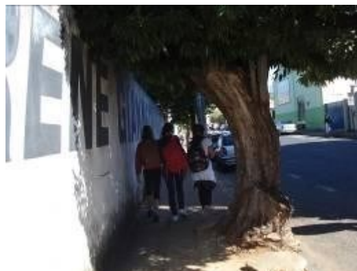
Fíg 03: Calçada soerguida pelas raízes da árvore. Fonte: Rodrigues, 2010
