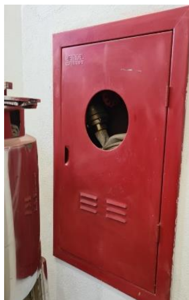
Figura 24 - Hidrante interno do Galpão
