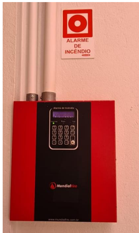
Figura 14 - Alarme de incêndio instalado na entrada da edificação
