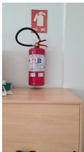
Figura 34 - Extintores de emergência do Laboratório Y
