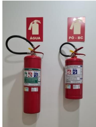
Figura 29 - Extintores do Laboratório Y
