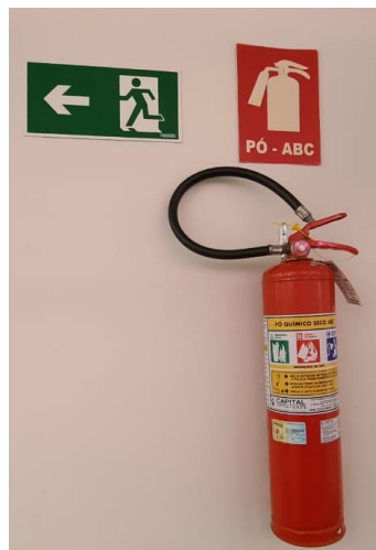
Figura 19 - Extintor presente no mezanino 2
