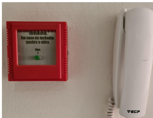
Figura 16 - Detalhes da instalação de alarme com acionamento manual
