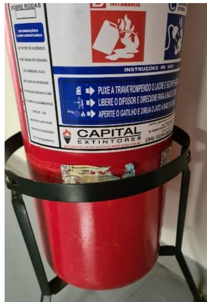
Figura 20 - Extintor presente no térreo
