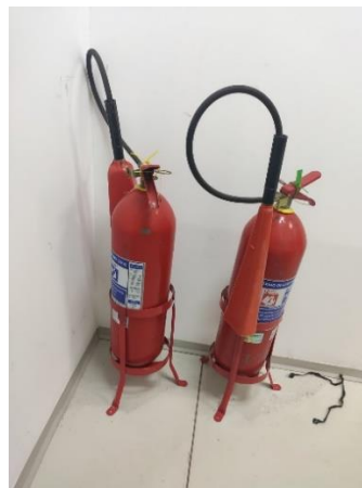
Figura 30 - Extintores de emergência do Laboratório Y
