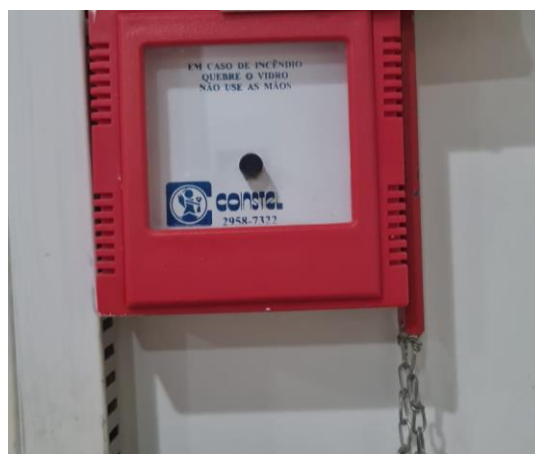
Figura 35 - Detalhes da instalação de alarme com acionamento manual
