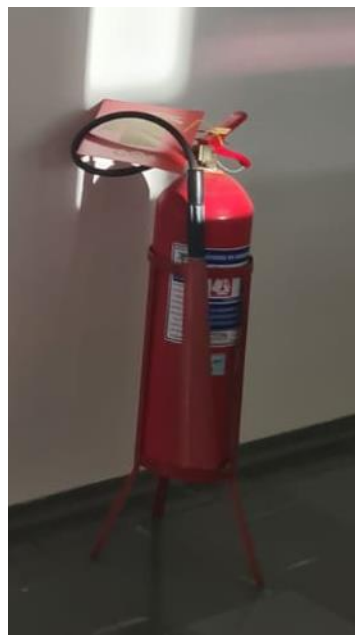
Figura 26 - Sinalização do extintor de CO_2 do mezanino 3
