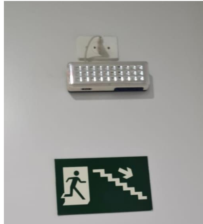
Figura 28 - Iluminação de emergência do Laboratório Y
