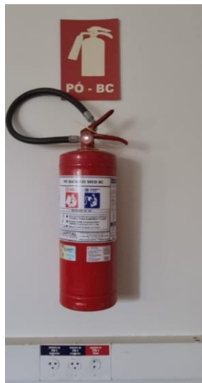
Figura 33– Extintores de emergência do Laboratório Y
