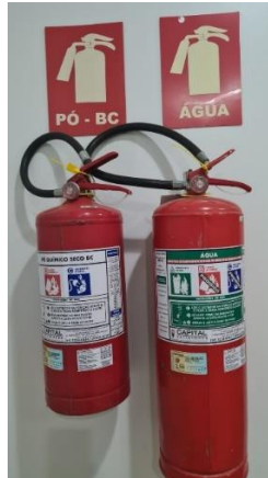
Figura 31– Extintores de emergência do Laboratório Y
