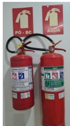
Figura 32– Extintores de emergência do Laboratório Y
