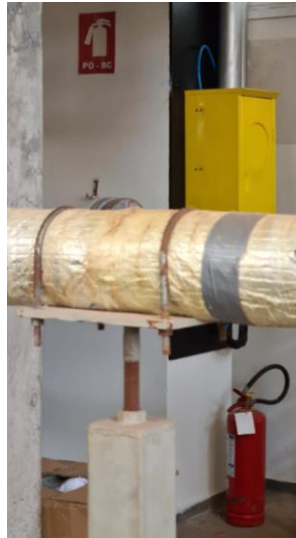
Figura 21 - Extintor presente no térreo abaixo da plataforma
