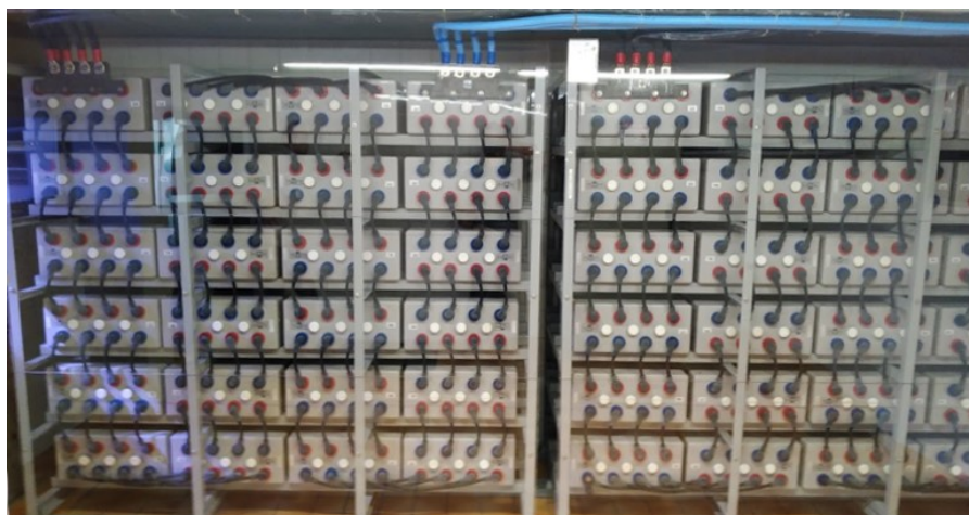
Figura 6 - Foto de banco de baterias instalado dentro de Data Center
