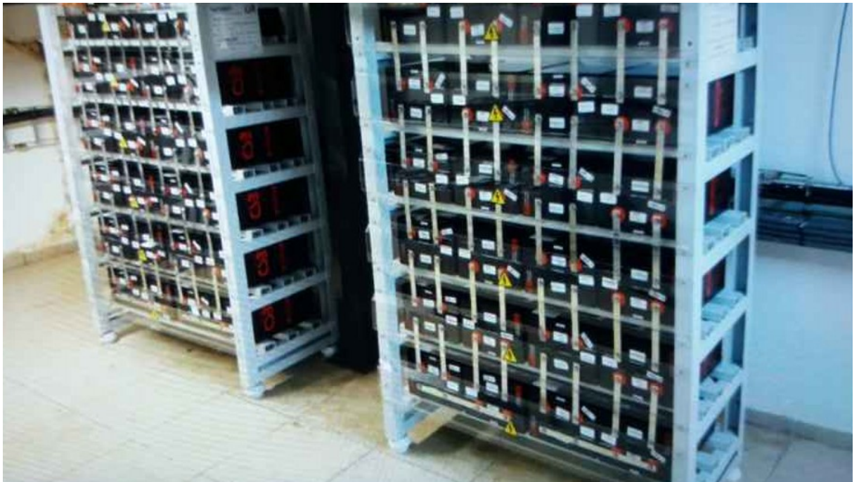
Figura 11 - Banco de Baterias recém instalado em estante
