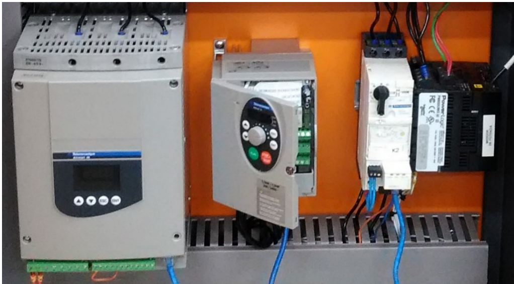
Figura 37 – Da esquerda para direita, soft starter (Telemecanique Altistart 48), inversor de frequência (Telemecanique Altivar 31), partida direta (Telemecanique Tesys IUCB05BI e Power Logic PM850UMG).
