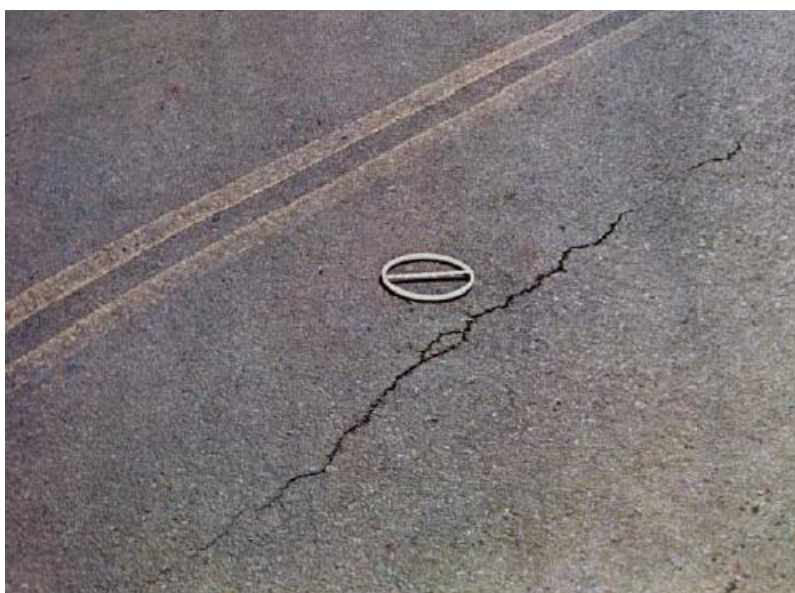
Figura 3 — Trinca isolada longitudinal
