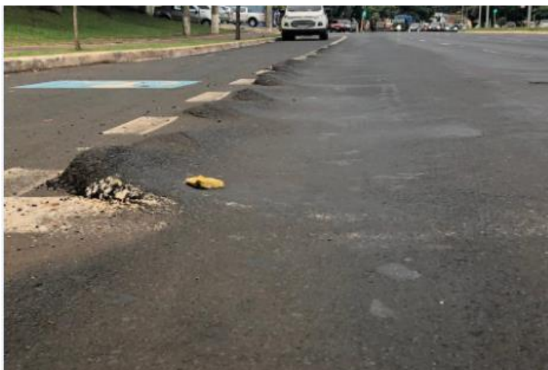
Figura 6 — Afundamento plástico das trilhas de roda
