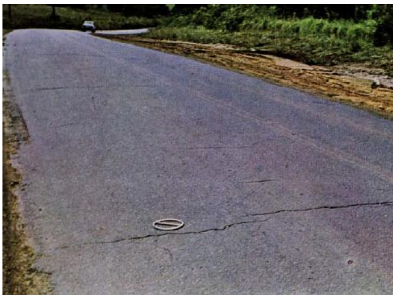
Figura 2 — Trinca isolada transversal
