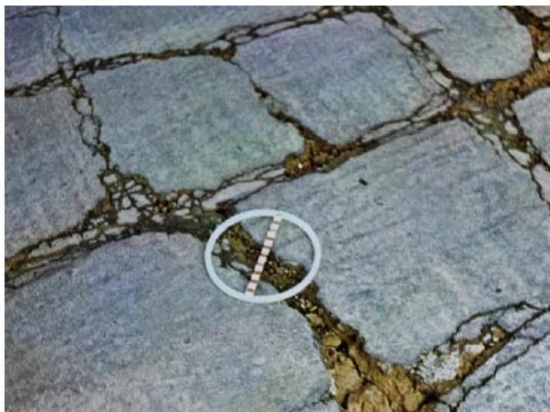
Figura 5 — Trinca interligada tipo "bloco"
