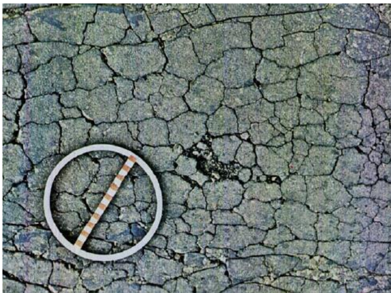
Figura 4 — Trinca interligada tipo "Couro de Jacaré"
