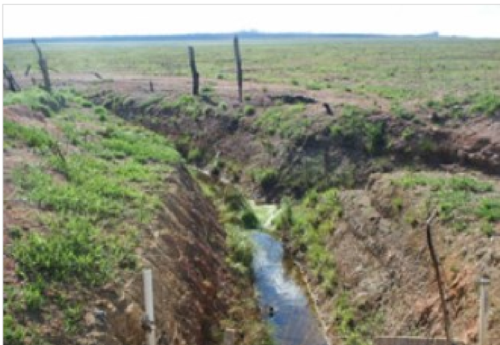
Figura 12. Topo da Chapada: Drenos abertos em covaais e veredas para baixar o nível hidrostático, lençol freático, para ampliação de áreas destinadas a atividades agropecuárias e produção de soja (2005)
