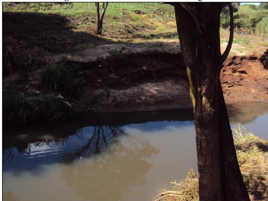
Figura 17: Erosão nas encostas e margens
