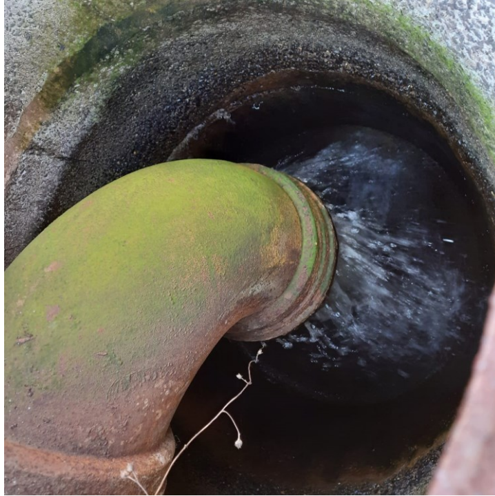
Figura 12 - Efluente final tratado na ETE Industrial antes de ser lançado no córrego.
