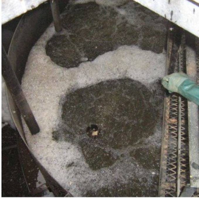
Figura 5 - Biofiltro aerado submerso da ETE Novo Horizonte.
