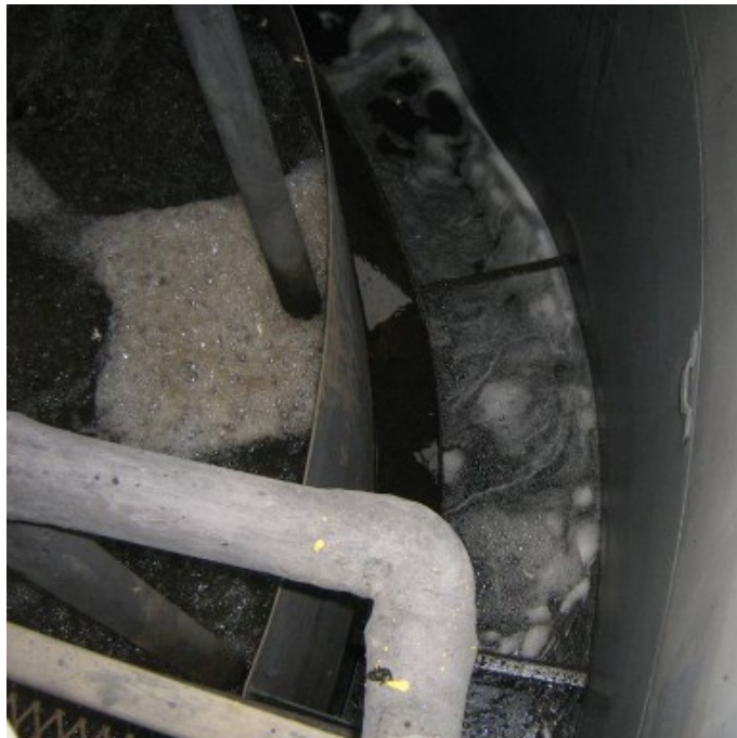
Figura 6 – Decantador secundário da ETE Novo Horizonte.
