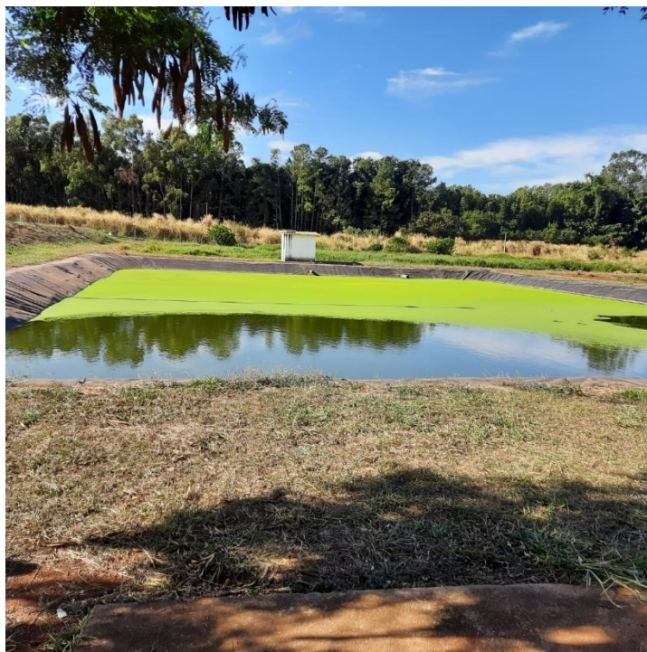
Figura 11 - Lagoa final de reuso da ETE Industrial.
