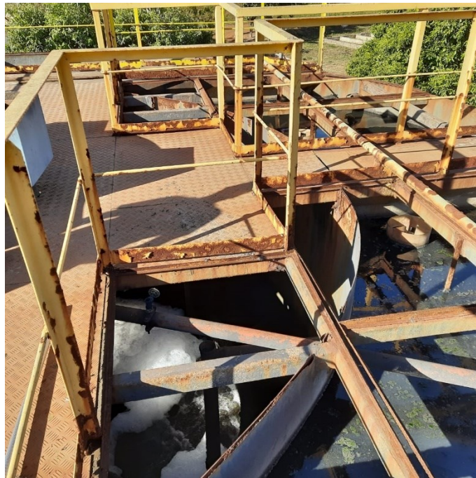
Figura 4 - Reator anaeróbio da ETE Novo Horizonte.
