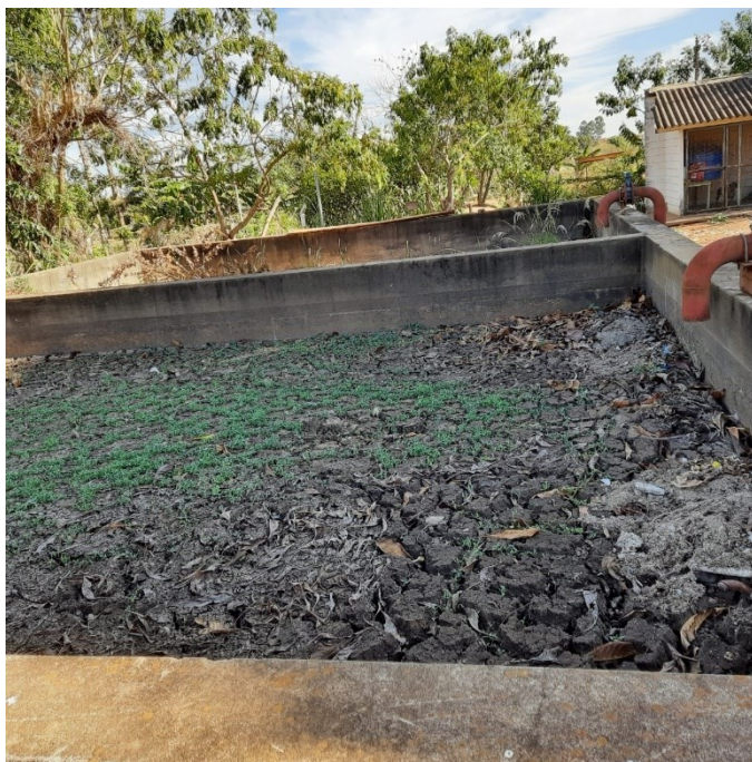
Figura 7 - Leitos de secagem da ETE Novo Horizonte.
