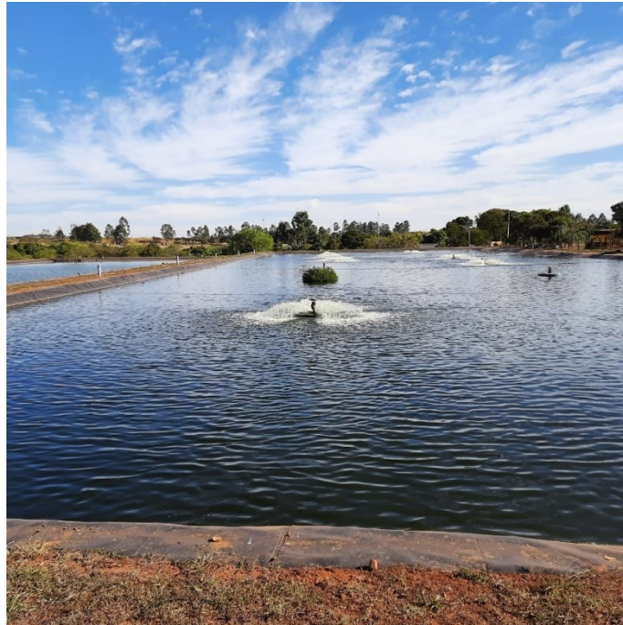
Figura 8 - Lagoa Facultativa Aerada na ETE Industrial.
