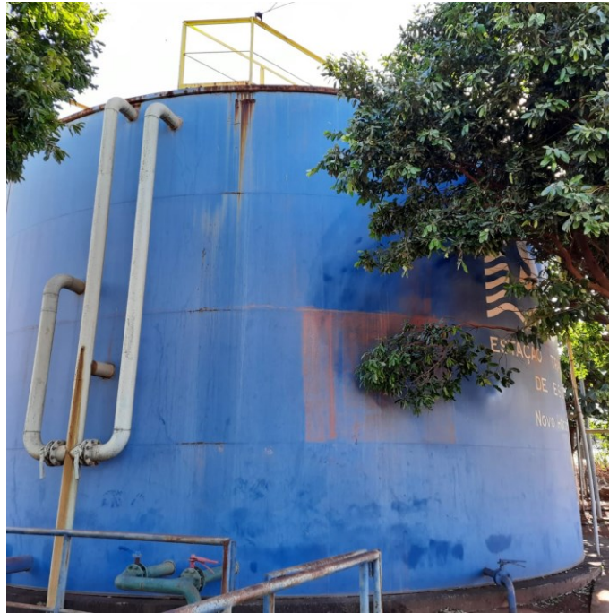
Figura 3 - Reator anaeróbio da ETE Novo Horizonte.
