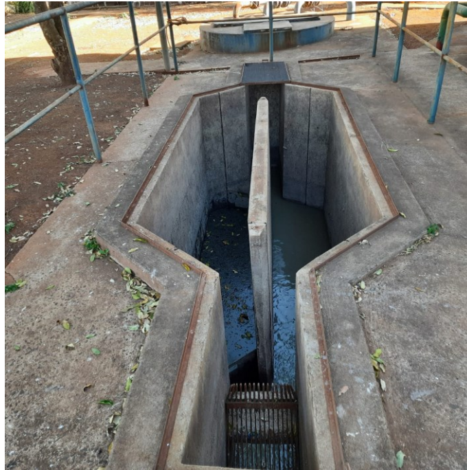
Figura 2 - Grades seguidas das caixas de areia da ETE Novo Horizonte.
