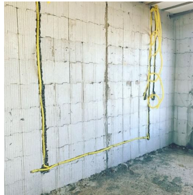
Figura 15 - Tubulações embutidas na parede.
