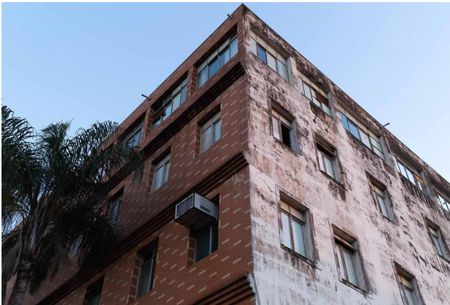
Contraste entre a fachada revestida de tijolo cerâmico e a empena seca. Ambas com patologias. Fonte: Antonio César Ortega.
