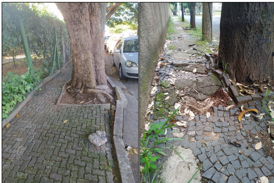
Figura 9 - Raízes quebrando a calçada e o pavimento.
