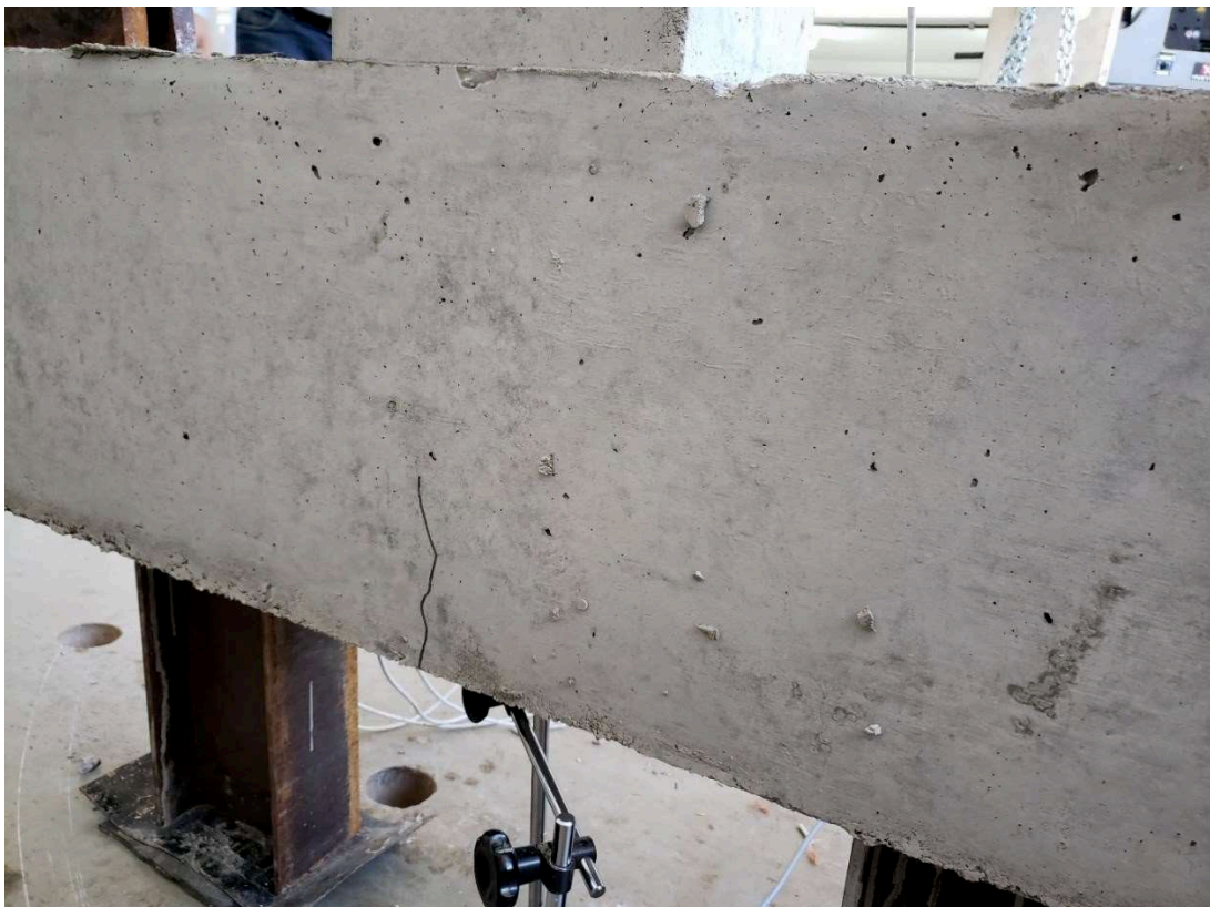
Figura 30 – Primeiras fissuras do bloco B20S na face posterior
