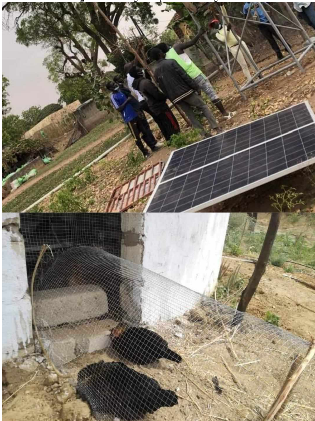
Figura 10: Montagem da placa solar e do galinheiro
