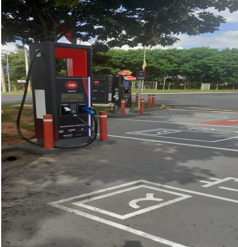
Figura 12: Ponto de carregamento de VEs, no posto GRAAL, interior de São Paulo
