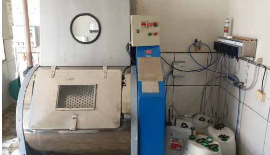
Figura 128: Lavanderia (Lavadora Horizontal). 2020. Fonte: Casa de Repouso da SSVP
