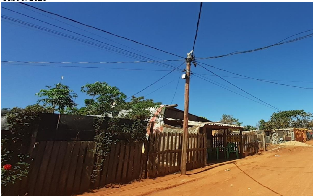
Figura 41: Uberlândia-MG: Fiação Clandestina de Energia Elétrica no Assentamento Fidel Castro. 2020
