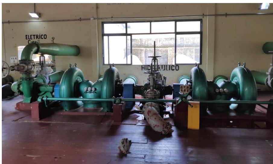
Figura 8 – Conjunto do sistema hidráulico, acionamento por turbinas hidráulicas.
