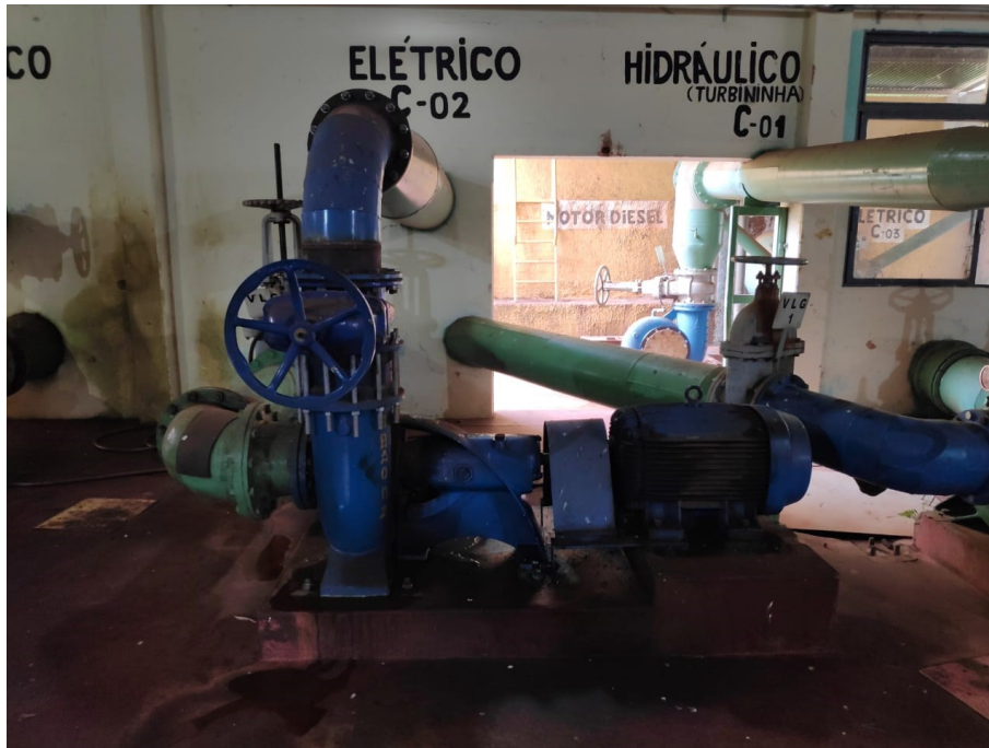
Figura 10 – Conjunto do sistema elétrico, acionamento por motor elétrico.
