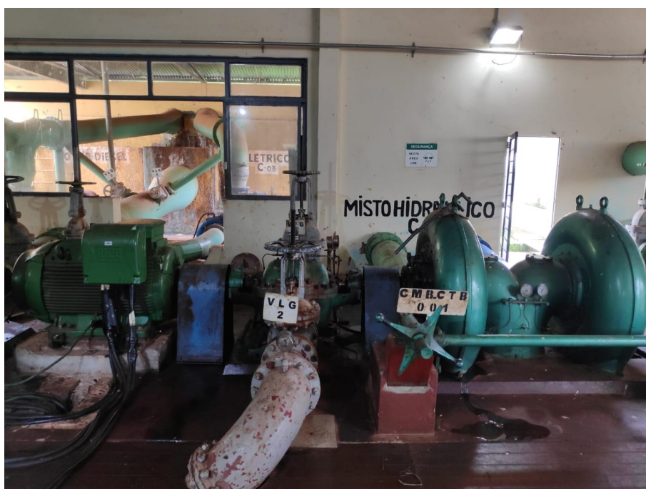
Figura 9 – Conjunto do sistema misto, acionamento por motor elétrico e turbina hidráulica.
