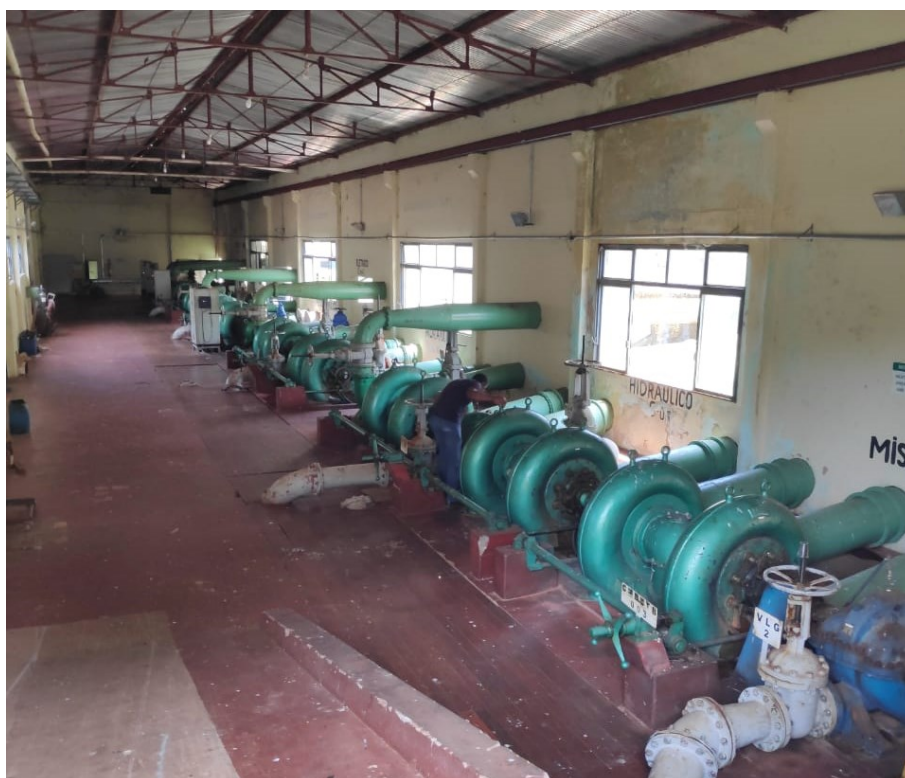
Figura 7 – Instalação existente na Casa de Máquinas da ETA Sucupira.
