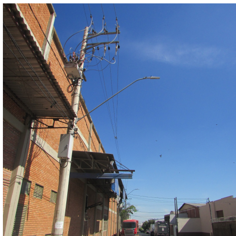
c) Religador de Distribuição 4 instalado no poste.
