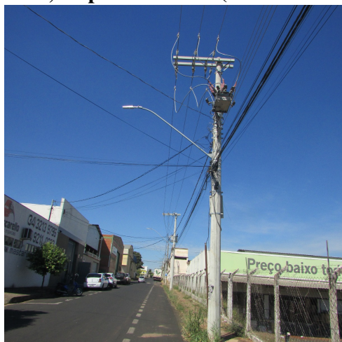
a) Religador de Distribuição 3 instalado no poste.
