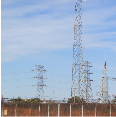
a) C1 - Linha de Transmissão (Alta Tensão).
