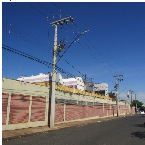
a) Religador de Distribuição instalado no poste.
