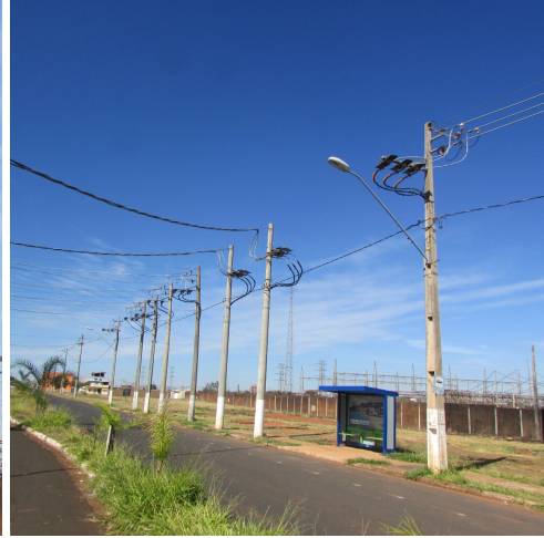
b) C2 - Av. Manuel Lúcio. Saída dos Alimentadores da Subestação.
