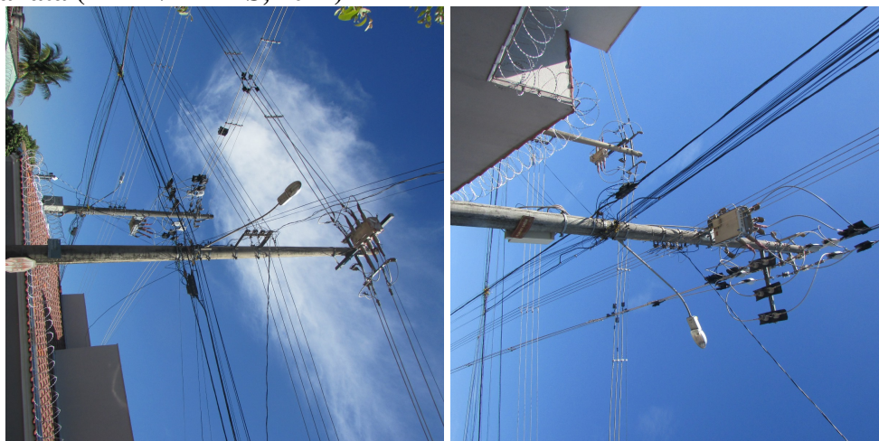
a) Religador de Distribuição 1, instalado no poste. b) Religador de Distribuição 1, imagem aproximada.
