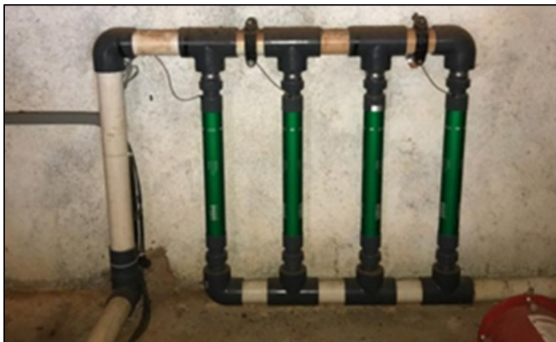
Figura 2: Eletromagnetizador instalado no sistema de irrigação localizada.
