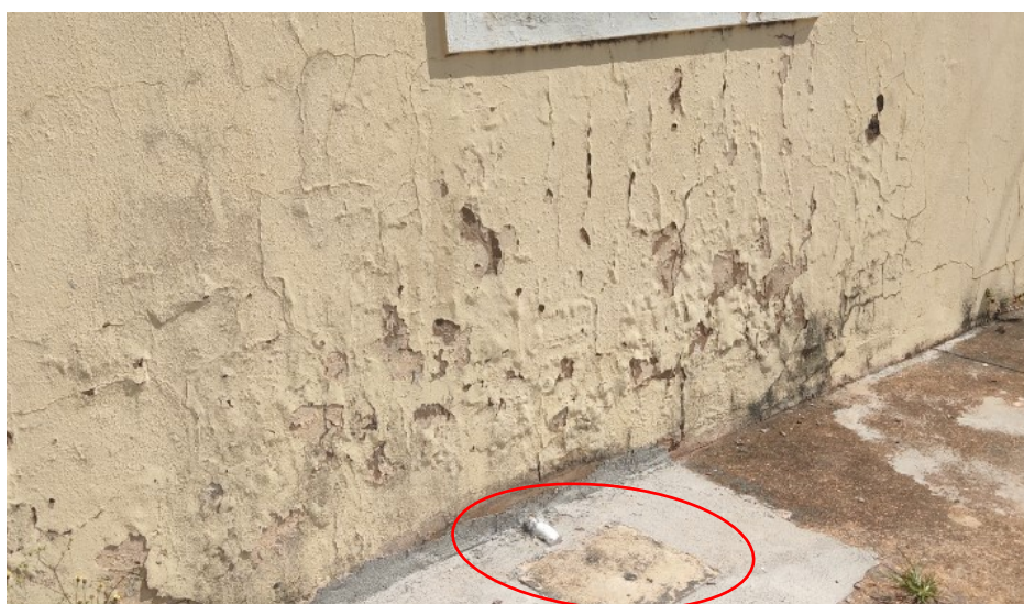
Figura 26 - Desagregação, empolamento e fissuração presentes na fachada sul da edificação G.
