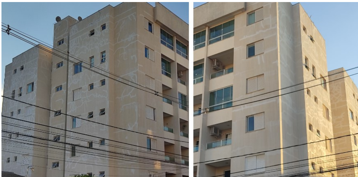
Figura 11 - Fissuras generalizadas presentes na fachada norte e sul da edificação C.
