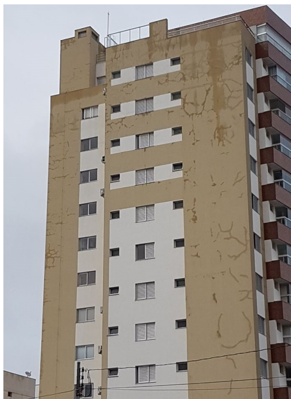
Figura 8 - Fachada com fissuras mapeadas devido à água das chuvas.
