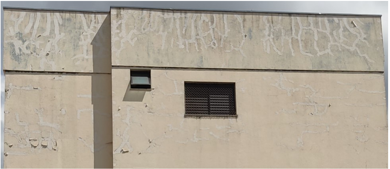
Figura 36 - Fissuração e descolamento da pintura na fachada norte da edificação K.
