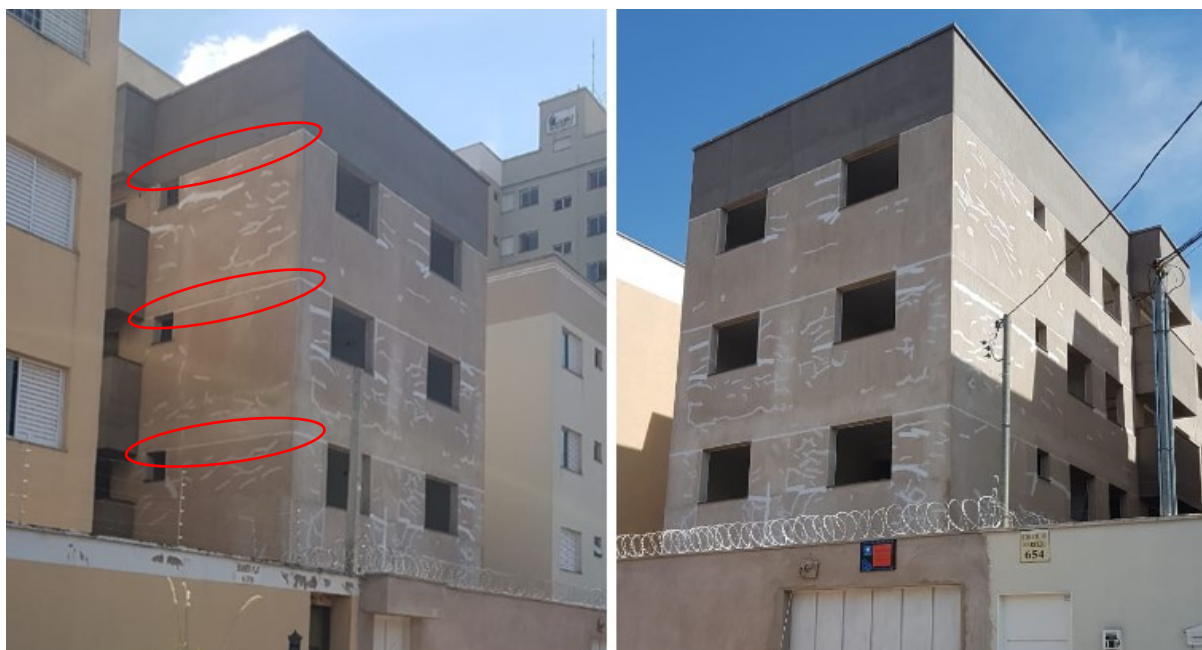
Figura 30 - Fissuração presente na fachada oeste da edificação I.
