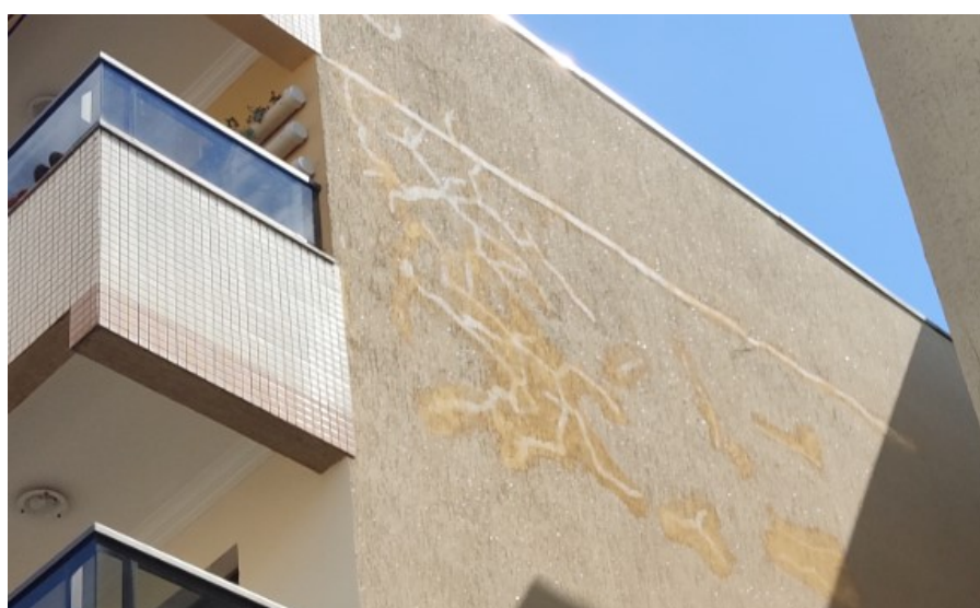
Figura 15 - Fissuras devidas à retração na fachada leste do edifício D.
