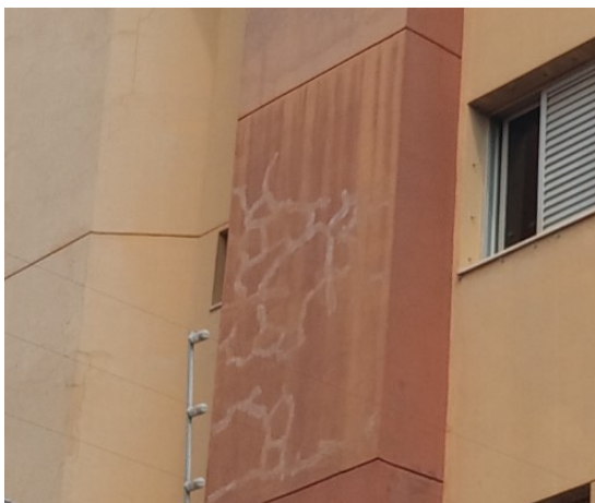
Figura 32 – Fissuração presente na fachada norte da edificação J.
