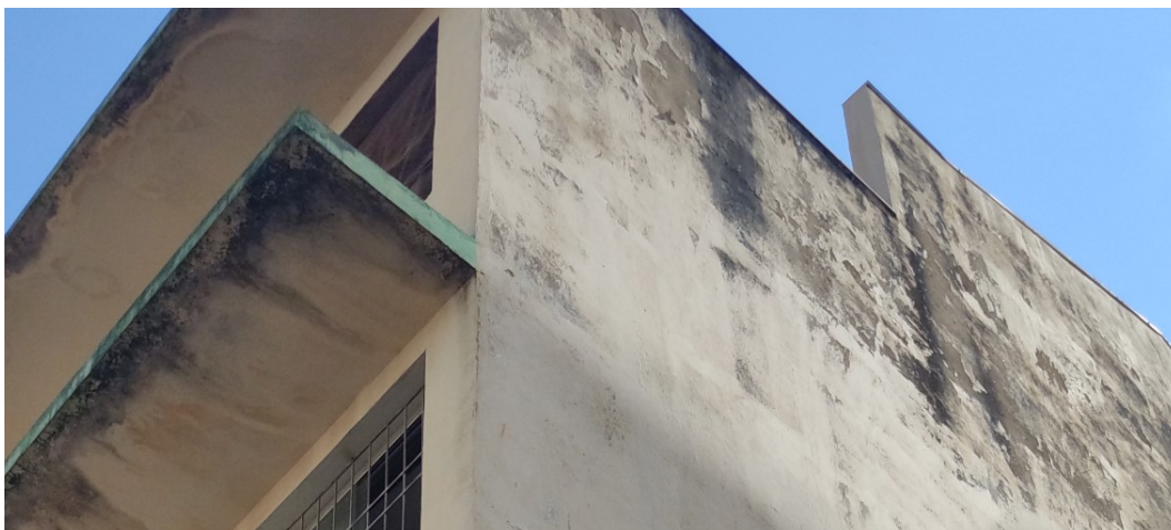
Figura 20 - Fungos presentes nas fachadas norte e leste da edificação F.
