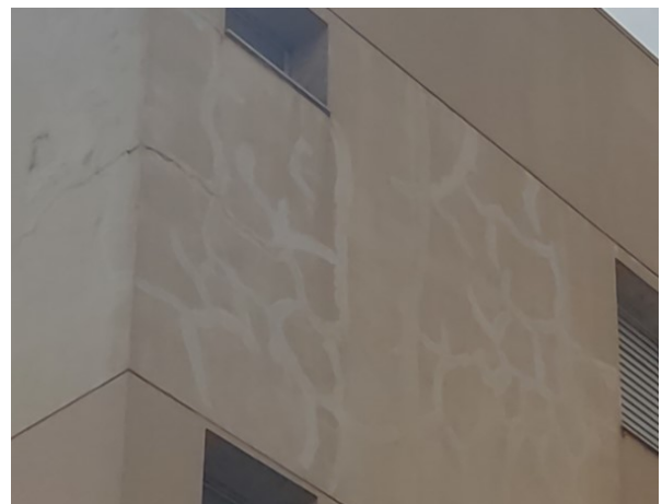
Figura 33 – Fissuração presente na fachada oeste da edificação J.
