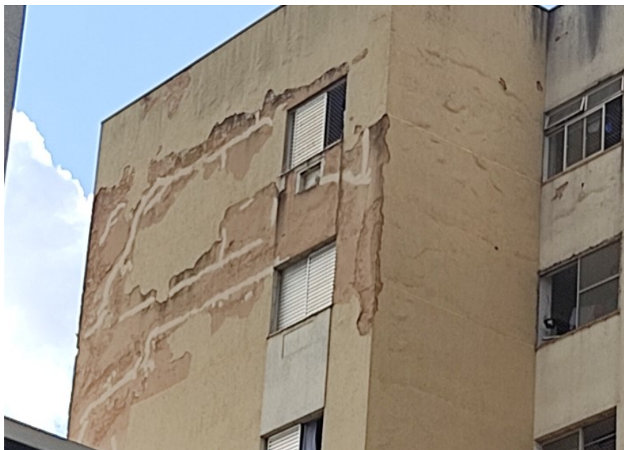
Figura 29 - Deslocamento do reboco e fungos na fachada sudoeste da edificação H.
