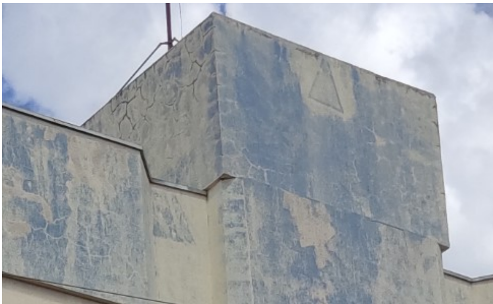
Figura 37 – Fissuração na fachada oeste da edificação K.
