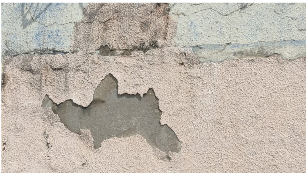
Figura 38 - Fissuração e desagregação no muro externo norte do edifício K.
