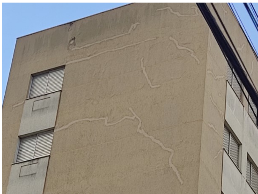
Figura 28 - Fissuras presentes na fachada sudoeste da edificação H.
