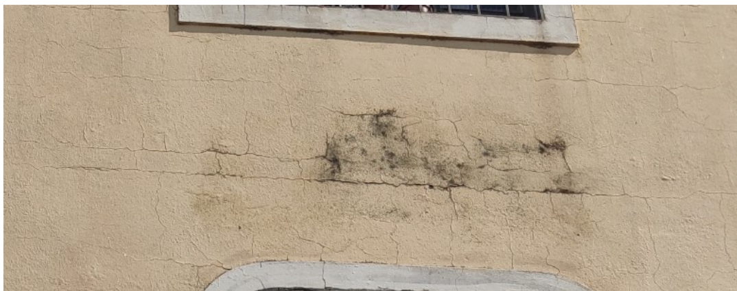
Figura 25 - Fissura advinda da mudança de base entre alvenaria e concreto.
