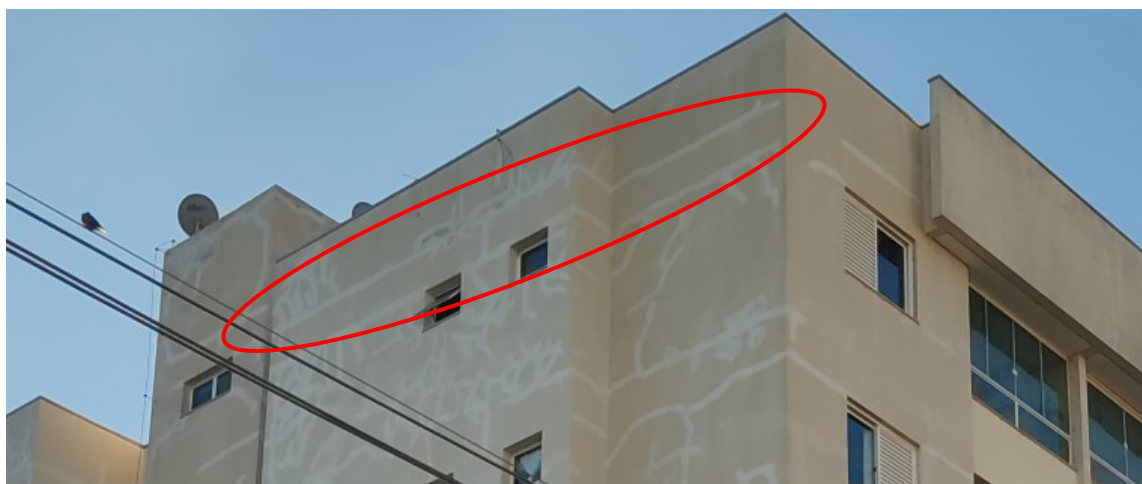
Figura 12- Fissuras presentes na transição entre alvenaria e vigas do edifício C.
