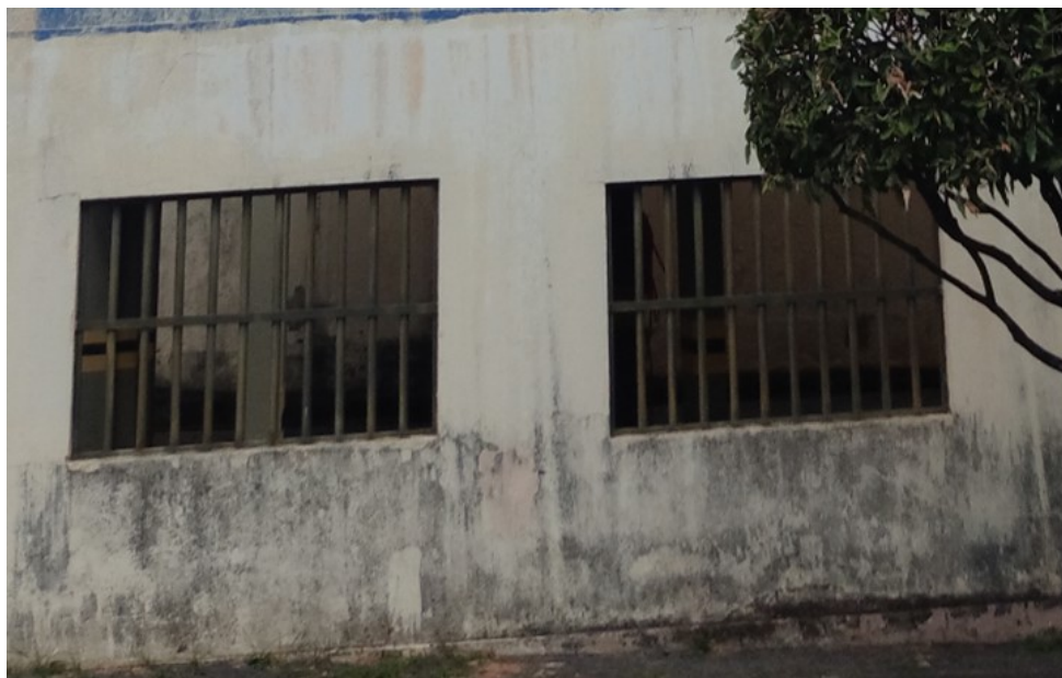
Figura 39 - Fungos e sujidades presentes no muro externo oeste do edifício K.
