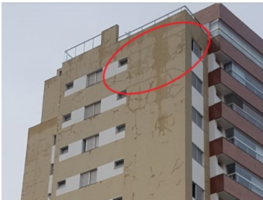
Figura 9 - Fissuras presentes na transição entre alvenaria e as vigas.
