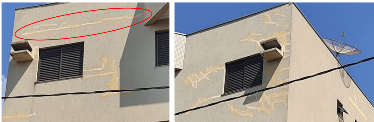
Figura 14 - Fissuras na fachada norte do edifício D.
