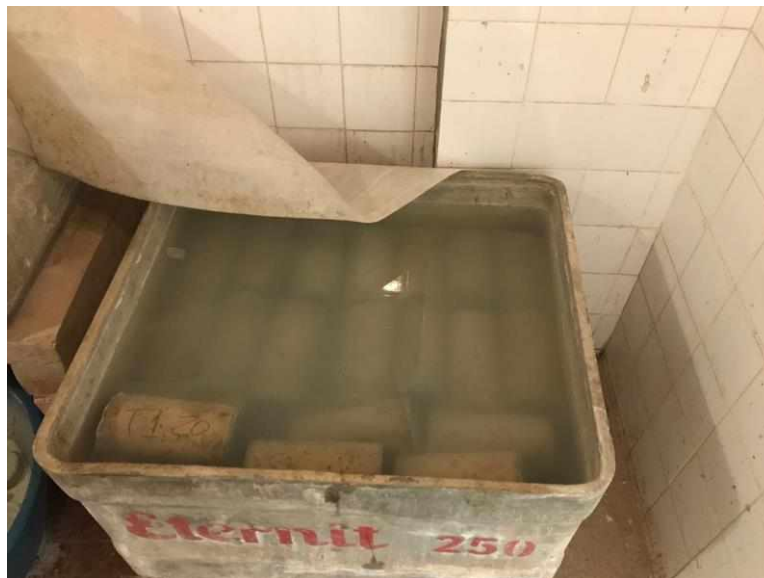
Figura 30 - Contaminação por NaCl do concreto
