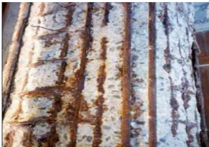
Figura 14- Pilar sobre o mar, após 10 anos de construção, deterioração por ataque da água.
