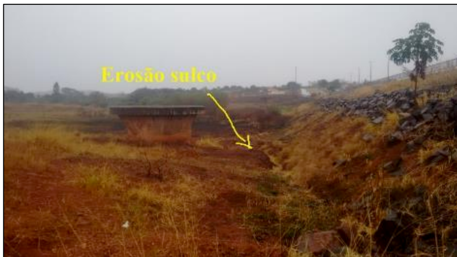
Figura 86. Processo de erosão em sulco no córrego Pirapitinga
