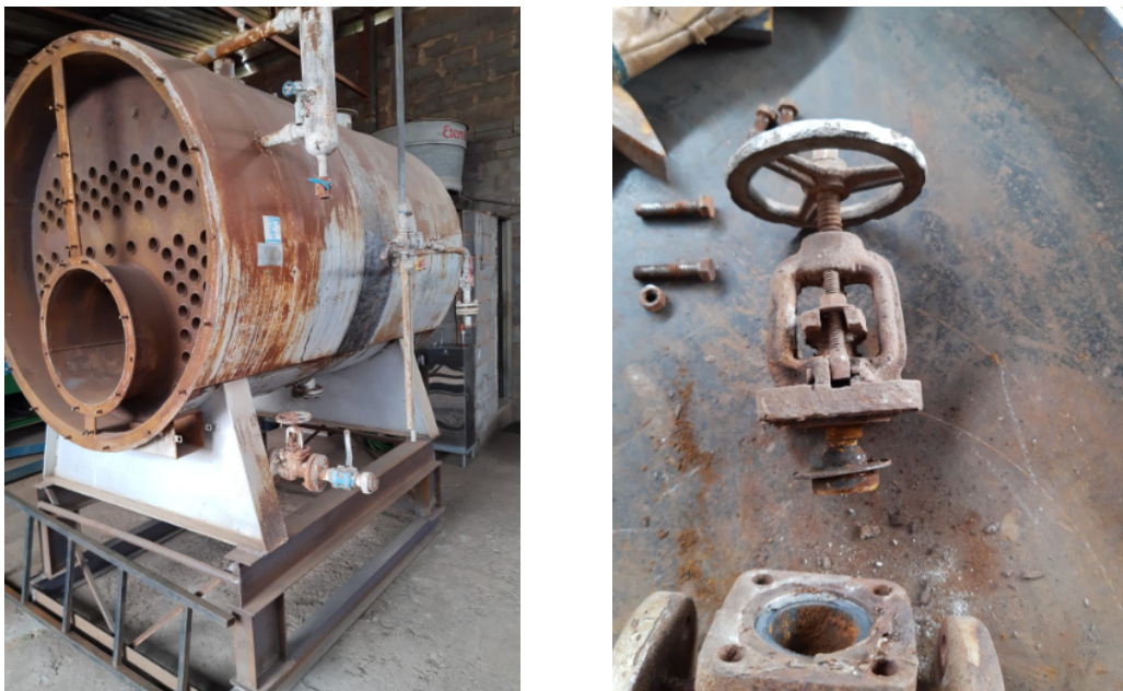
Figura 14 – À esquerda, a caldeira onde a válvula era utilizada. À direita, a válvula antes de sua limpeza.
