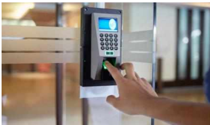
Figura 21 – Sistema de trava/destrava biométrica em portas.
