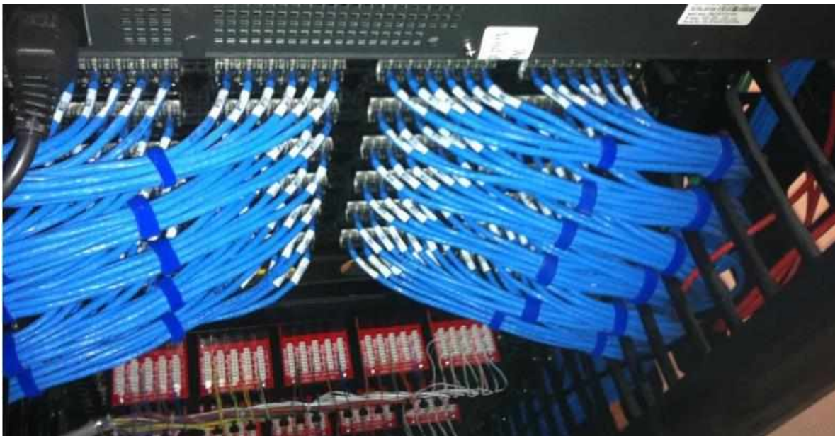
Figura 9 – Sistema de cabeamento.
