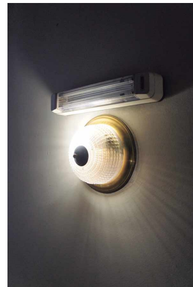
I9 Iluminação da Circulação
