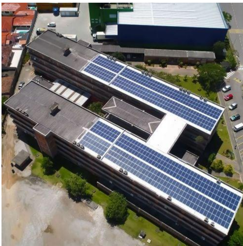
Figura 36 - Minigeração fotovoltaico instalado na cidade de Biguaçu/Santa Catarina (EGNEX)
