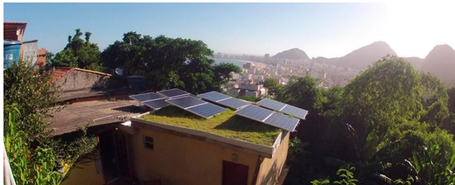
Figura 3 - Placas fotovoltaicas no telhado de uma residência na comunidade Babilônia, Rio de Janeiro. (SOLAR, 2020)
