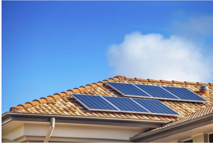
Figura 37 - Sistema de microgeração fotovoltaica (BLUESOL, 2016)
