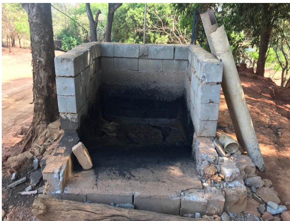
Figura 6 - Caixa de passagem no início do sistema de tratamento.
