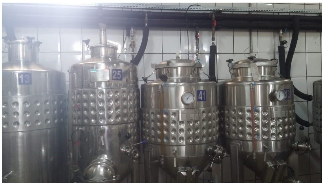
Figura 31 - Tanques de aço inoxidável utilizados para as fermentações.
