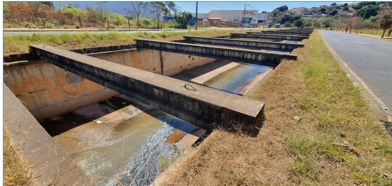
Figura 149 – Araxá: córrego com presença de esgoto a céu aberto. Fonte: Souza (2020).
