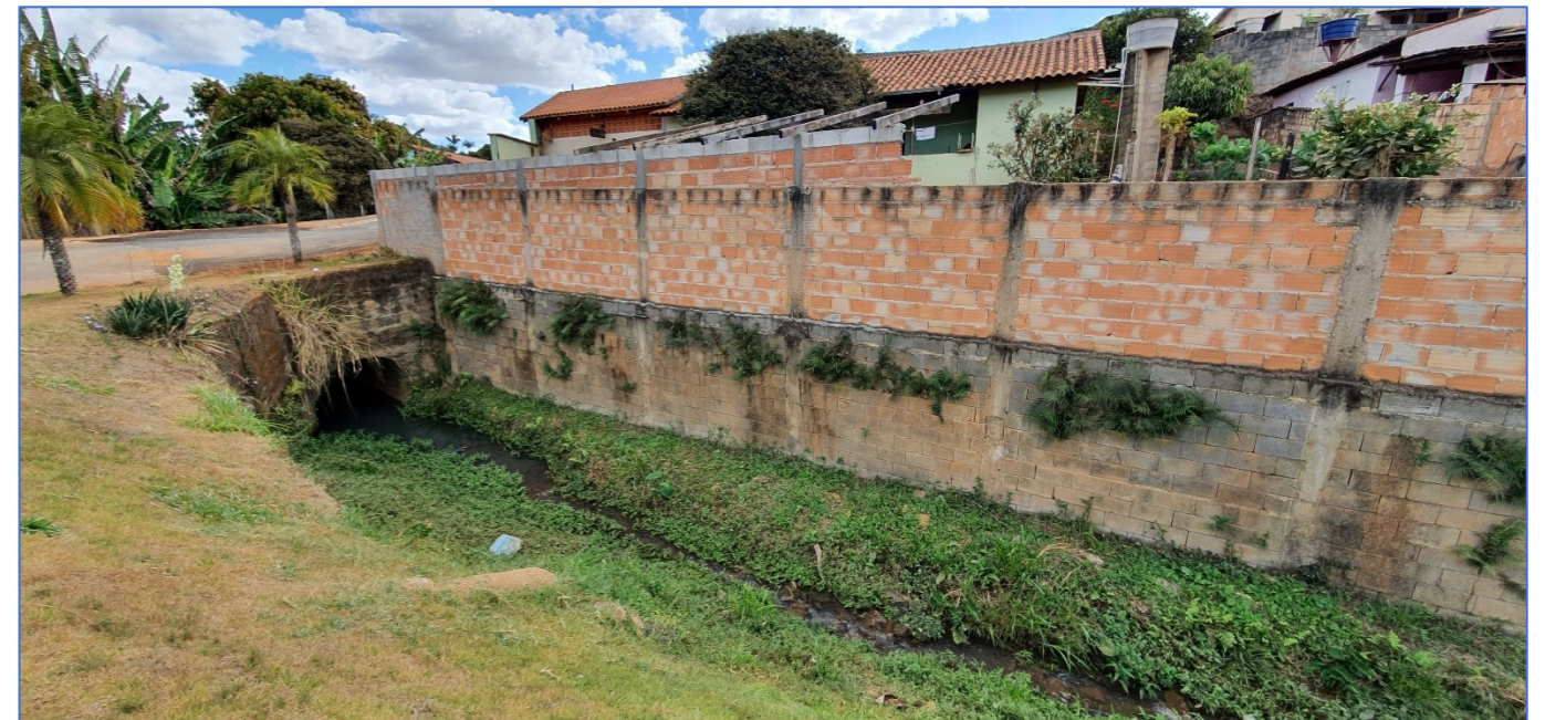
Figura 152 – Tapira: córrego com presença de esgoto a céu aberto. Fonte: Souza (2020).
