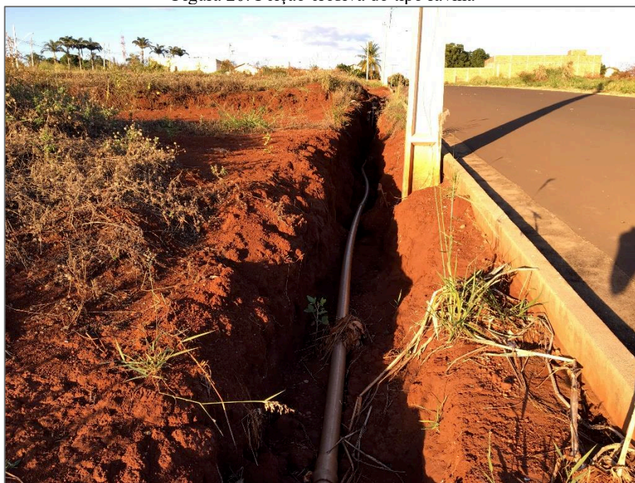
Figura 20: Feição erosiva do tipo ravina
