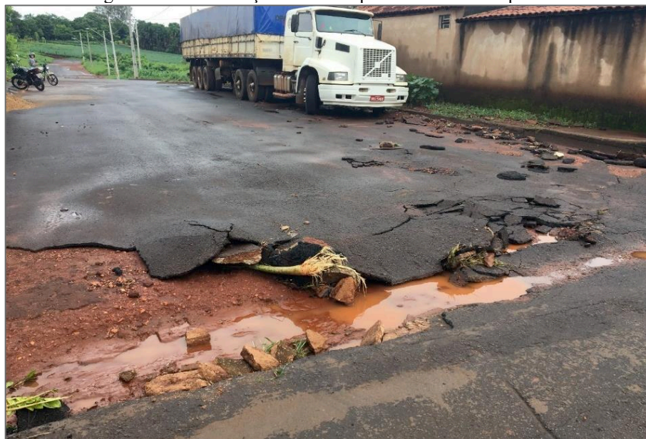
Figura 15: Pavimentação removida pelo escoamento superficial
