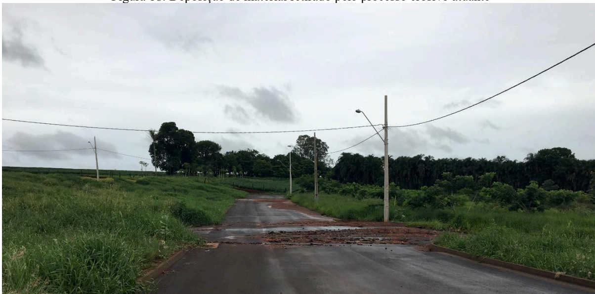
Figura 18: Deposição de material retirado pelo processo erosivo atuante
