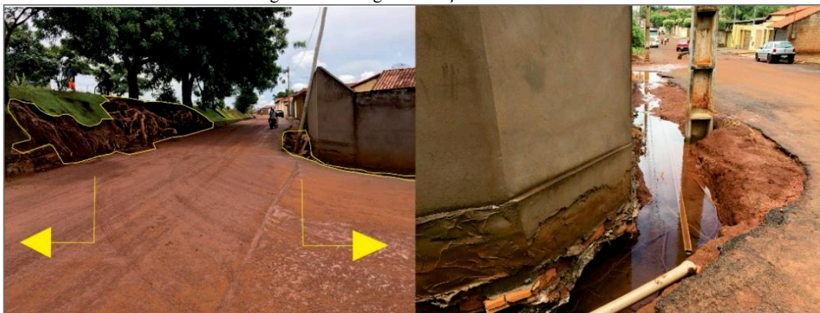
Figura 30: Estragos no calçamento e asfalto
