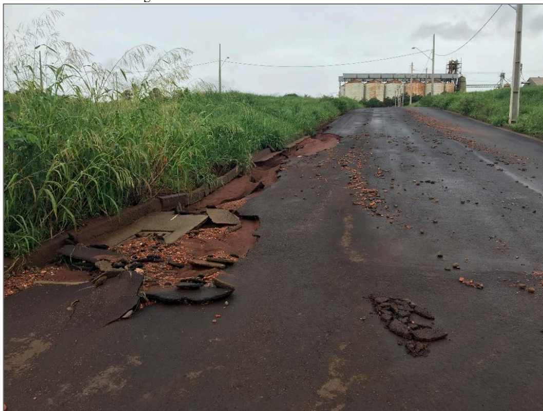
Figura 17: Retirada de material da vertente formando erosões
