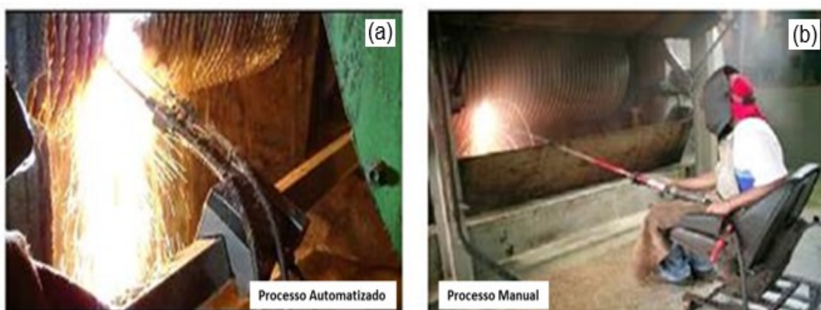
Figura 2.9 – Aplicação automatizada (a) e manual (b) do chapisco durante a sua operação. (MURAD, 2015)
