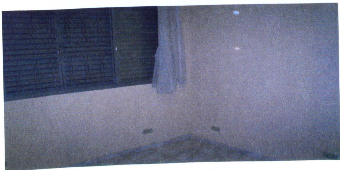
Figura 5.1.3 - Parede frontal e parte da parede direita, sem tratamento.
