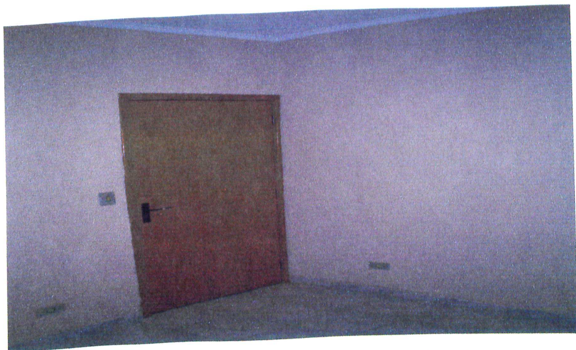
Figura 5.1.6 - Parede de fundo e parte da parede esquerda, sem tratamento.
