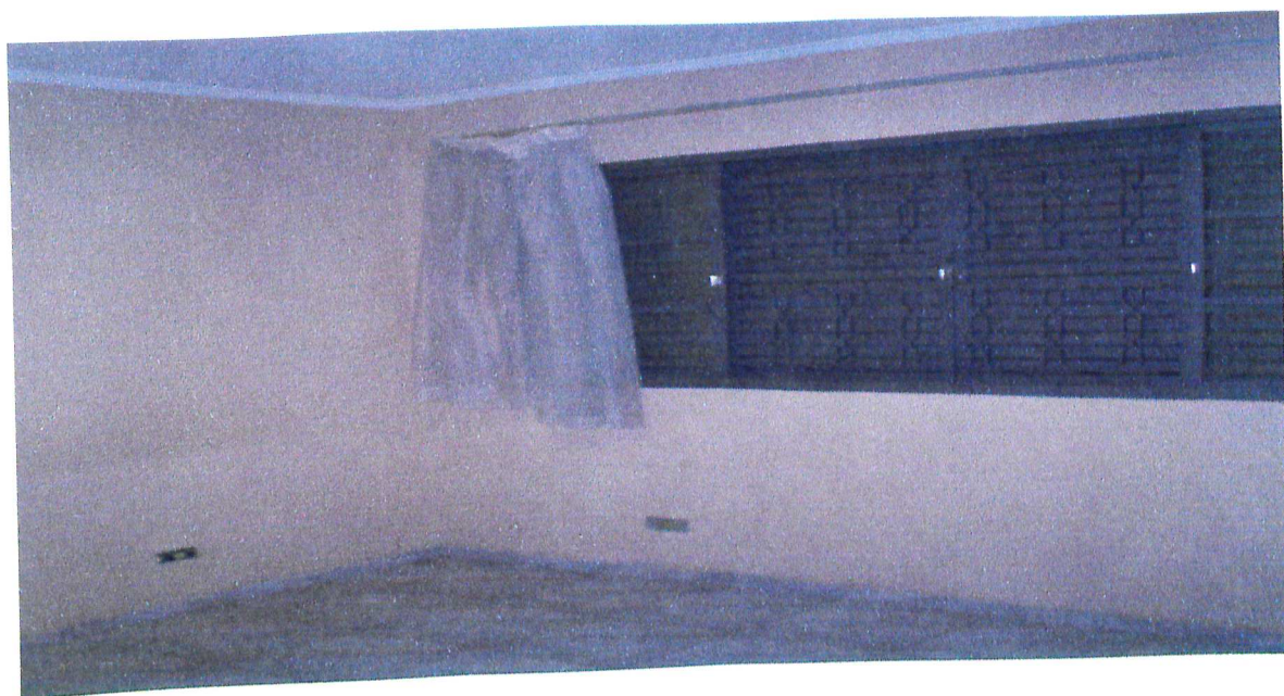
Figura 5.1.5 - Parede esquerda e parede de frente, sem tratamento.
