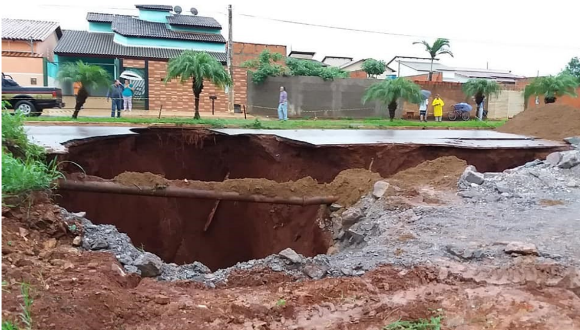
Figura 11. Fotografia da dolina na Avenida Geraldo Campos, bairro Vazante Sul, Vazante (MG), (2019)
