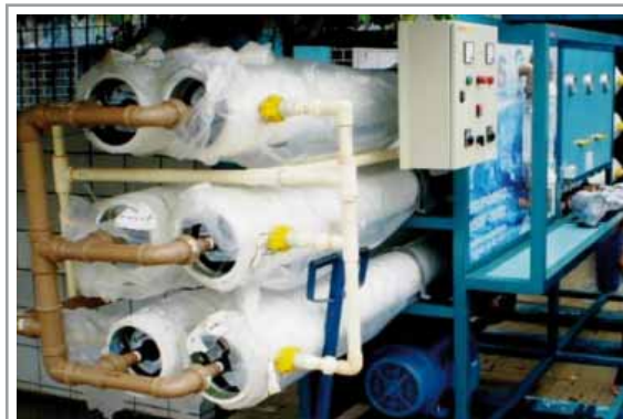
Equipamento de grande vazão para tratamento de água por osmose reversa . Foto: HS Osmose Reversa (2015).
