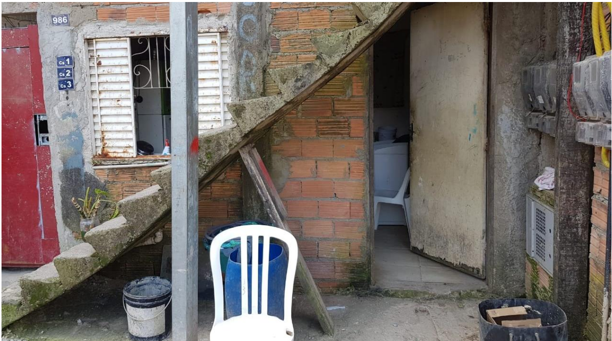
Figura 1.3 – Elemento estrutural em colapso sendo sustentado por uma peça de madeira na Favela do Boqueirão, São Paulo.
