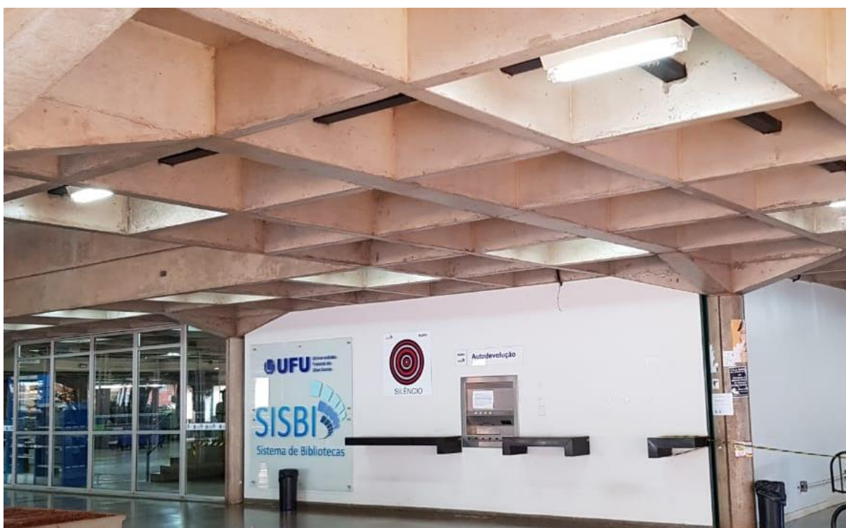
Figura 3.8 – Laje nervurada na Biblioteca da Universidade Federal de Uberlândia, Campus Santa Mônica
