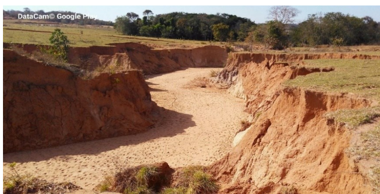
Figura 6 – Voçoroca no município de Coxim-MS
