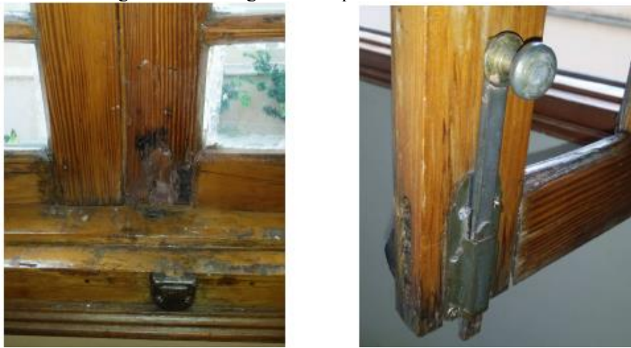
Figura 24: Patologias das esquadrias do salão nobre
