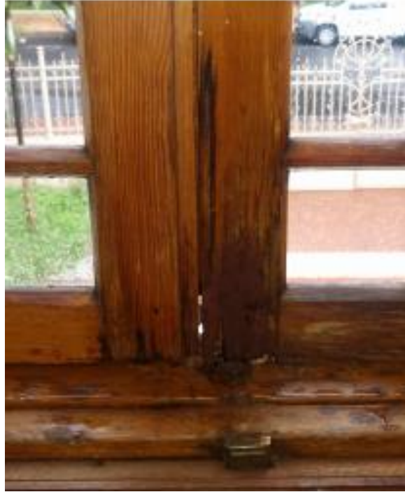
Figura 22: Detalhe da patologia da esquadria voltada para a lateral
