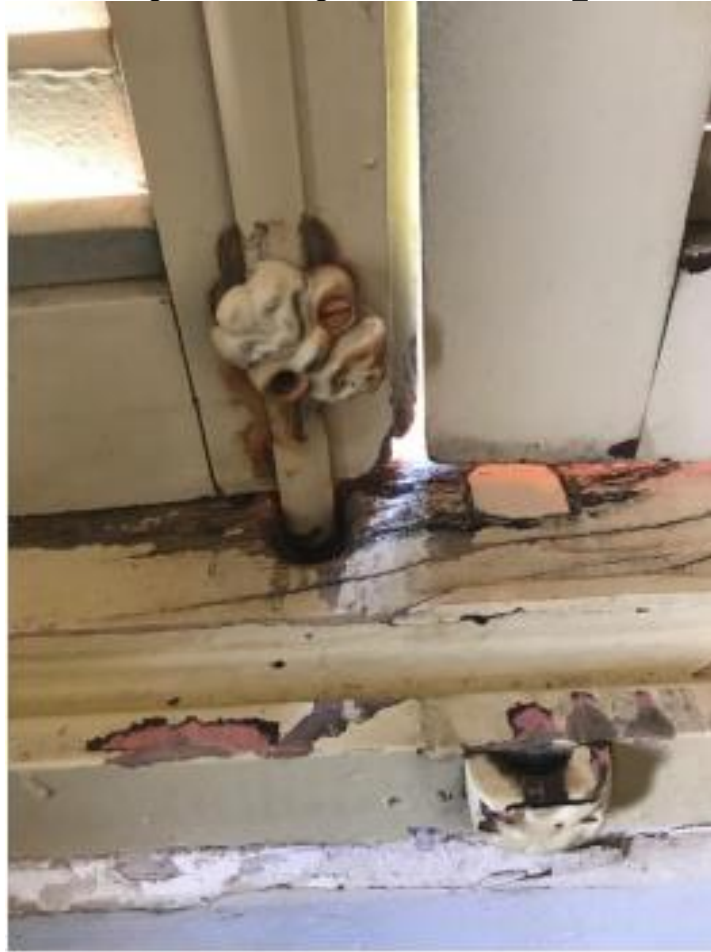
Figura 37: Ferragem deteriorada da J1_2
