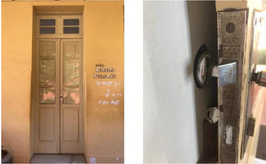
Figura 42: P1_1 com perda de massa de vidraceiro e lesionando a parede
