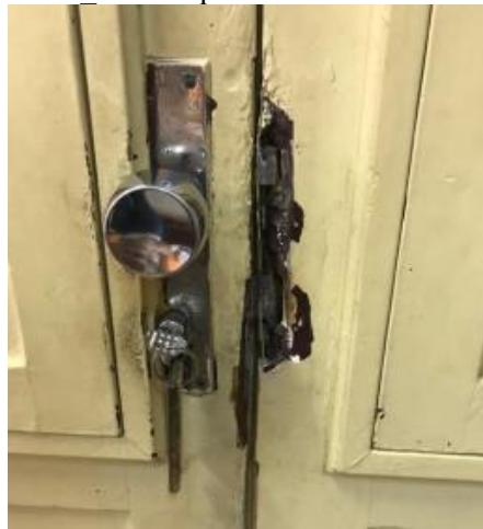
Figura 44: P1_10 com perda de madeira na fechadura
