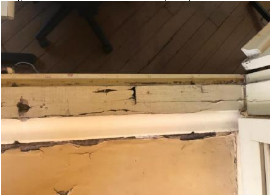
Figura 36: Peitoril da J1_1 com deterioração da pintura e da madeira
