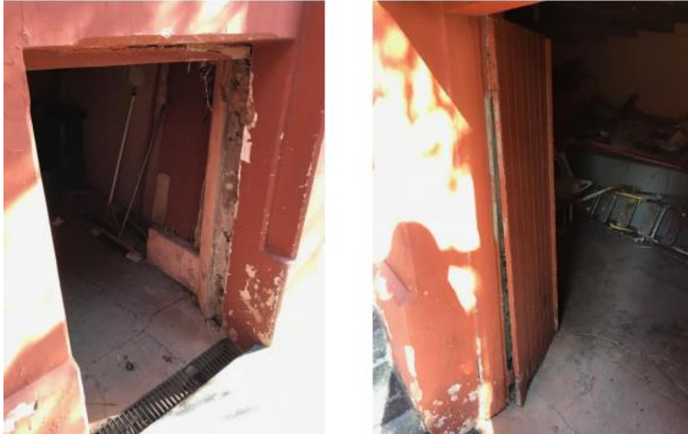
Figura 45: P5 com parte de baixo apodrecidas, batente se soltando e dobradiças com mal funcionamento
