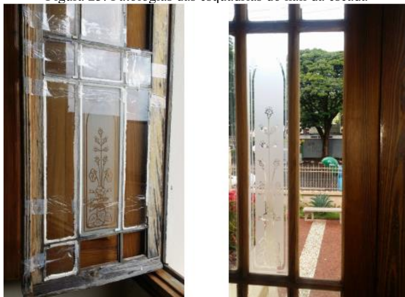
Figura 23: Patologias das esquadrias do hall da escada
