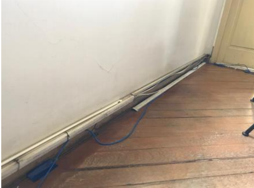
Figura 30: Caneletas quebradas e fiação solta na sala de área 20,13 m 2
