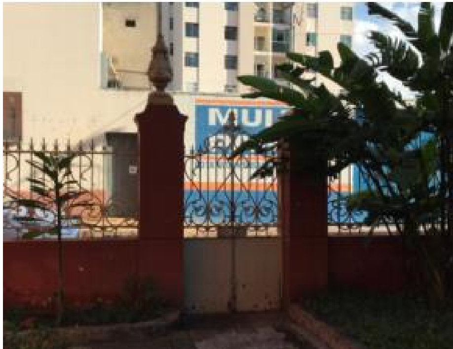
Figura 35: Portão de pedestres com pináculo faltando
