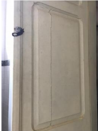
Figura 43: P1_7 com rachaduras e trinco quebrado
