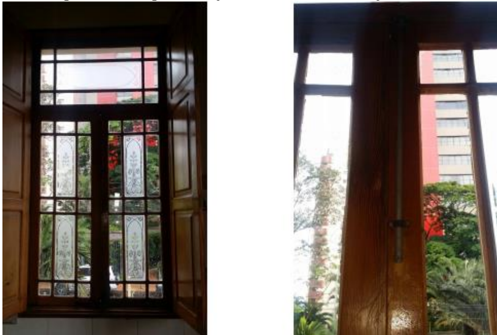
Figura 21: Patologias das esquadrias da cozinha voltada para a lateral
