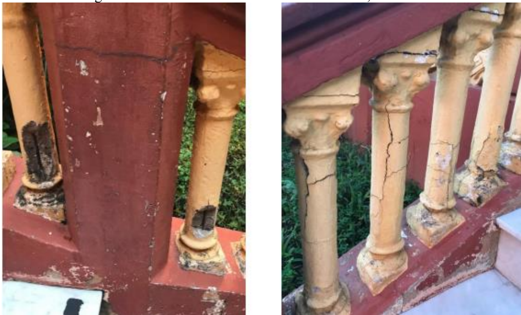
Figura 34: Balaústres dos corrimões das escadas, no Bloco B
