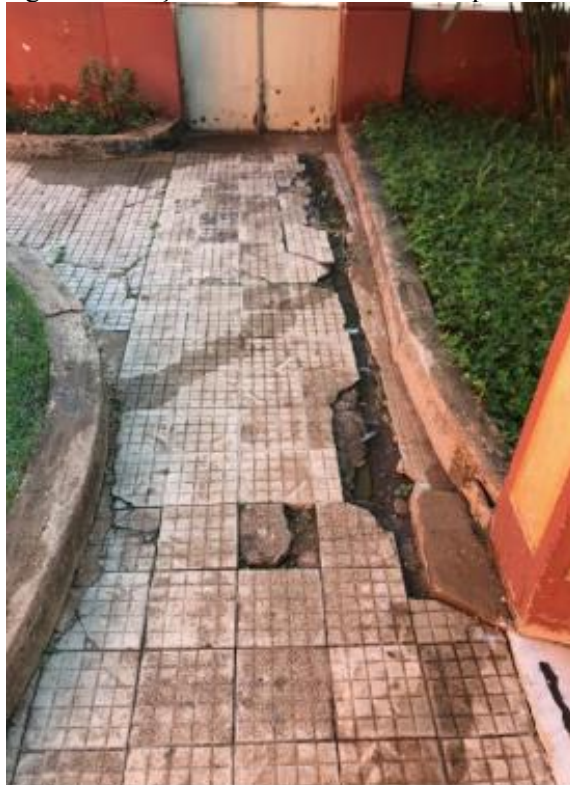
Figura 51: Peças de ladrilho hidráulico quebrados
