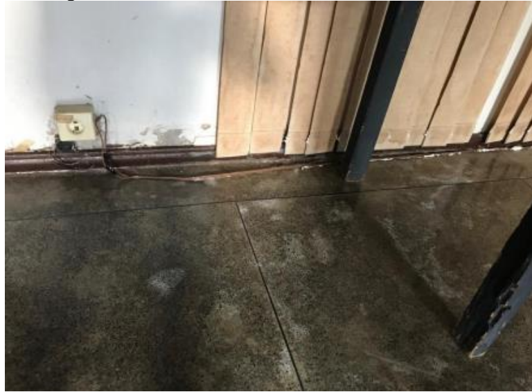
Figura 32: Caneletas faltantes na sala de área 20,92 m 2
