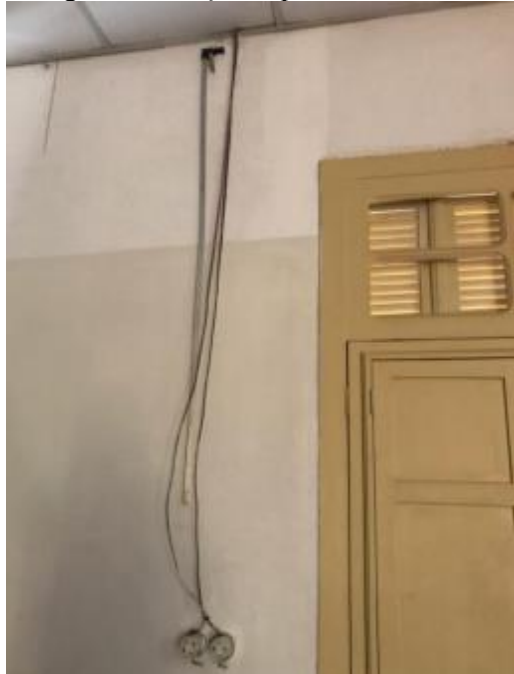
Figura 31: Fiação exposta no auditório
