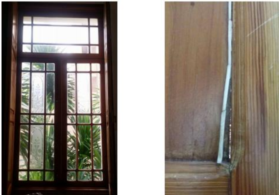
Figura 17: Patologias nas esquadrias do banheiro masculino
