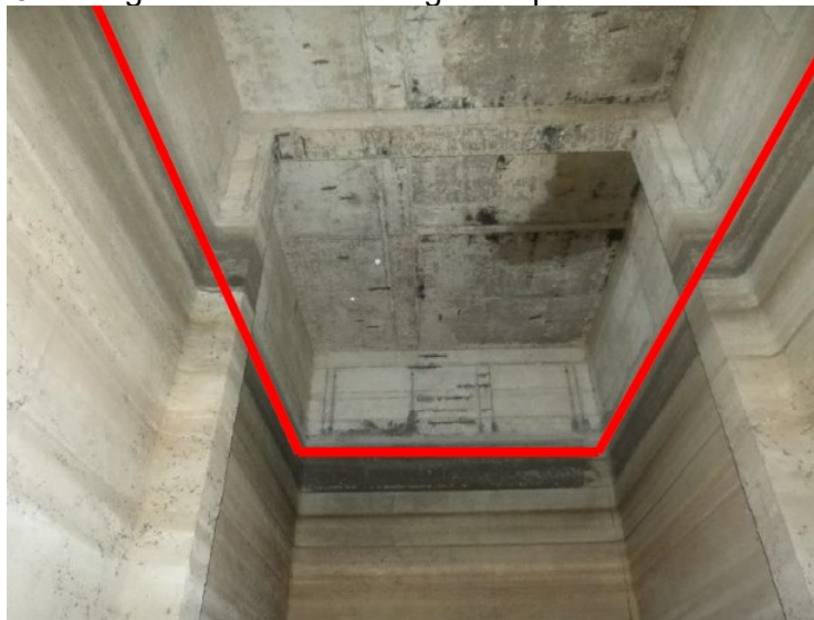
Figura 13 – Desgaste sobre linha d'água na parte interna do reservatório
