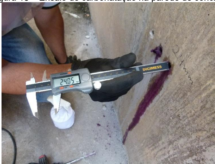
Figura 18 – Ensaio de carbonatação na parede de concreto
