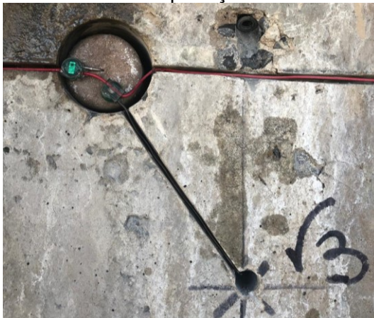
Figura 31 - Detalhe do sistema de proteção catódica instalado no concreto
