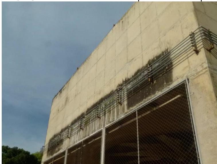
Figura 16 – Umidade na face externa da parede causada pelo sulco
