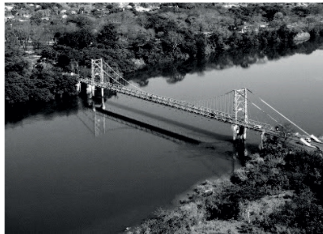
Figura 36: Ponte Afonso Pena, que marca a divisa inter-estadual, atualmente configura-se como a ponte pêncil mais antiga do país.
