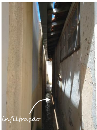
Figura 91: Afastamento do muro - Anexo I. 2019. Fonte: Autora.
