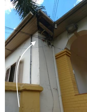
Figura 86: Fiação Elétrica. 2019. Fonte: Autora.
