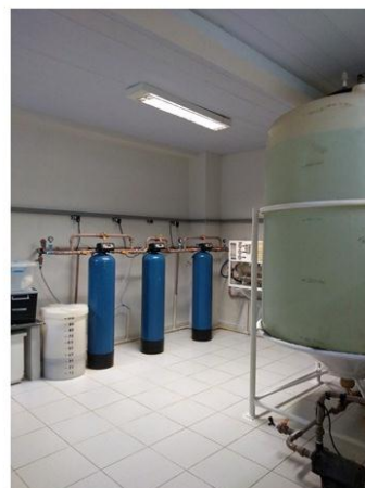
Sala de tratamento e reserva de água tratada
