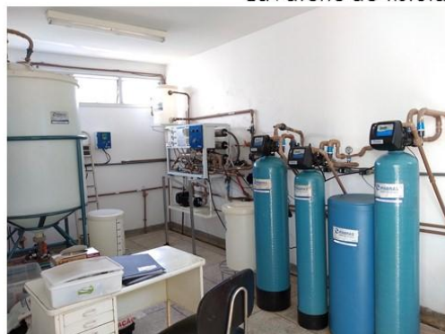
Sala de tratamento e reserva de água tratada
