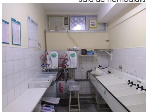
Sala de reprocessamento
