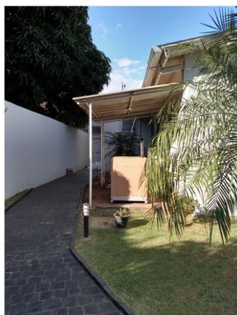
Área do gerador
