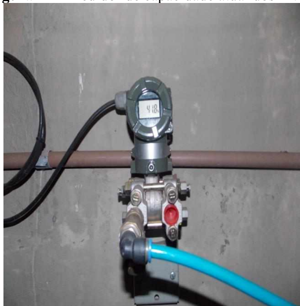
Figura 12 – Medidor de capacidade atual dos filtros.
