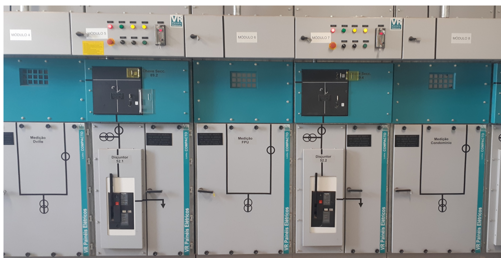
Figura 7 – Cubículo Média Tensão
