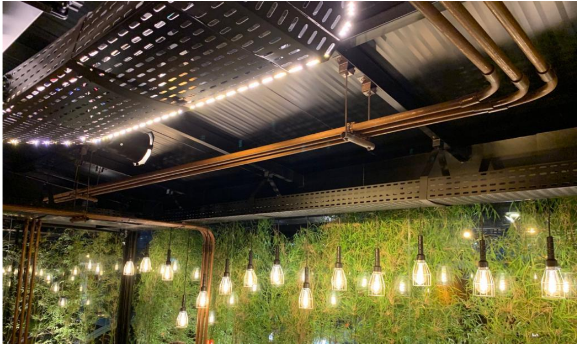
Figura 38: Exemplo de instalações elétricas aparentes Fonte: Autor (2019)
