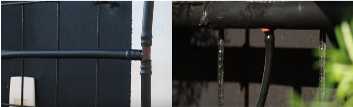
FIGURA 13 – Detalhe do sistema de gotejamento em cada vaso acoplado as treliças.
