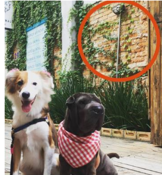
Figura 33: Iluminação com tubulação aparente.
